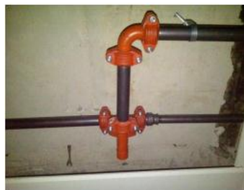
Figura 15: Soporte y tubería red contra incendio
