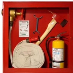
Figura 13: Gabinete contra incendio
