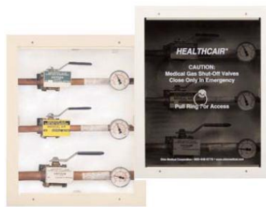
Figura 19: Cajas válvulas de corte
