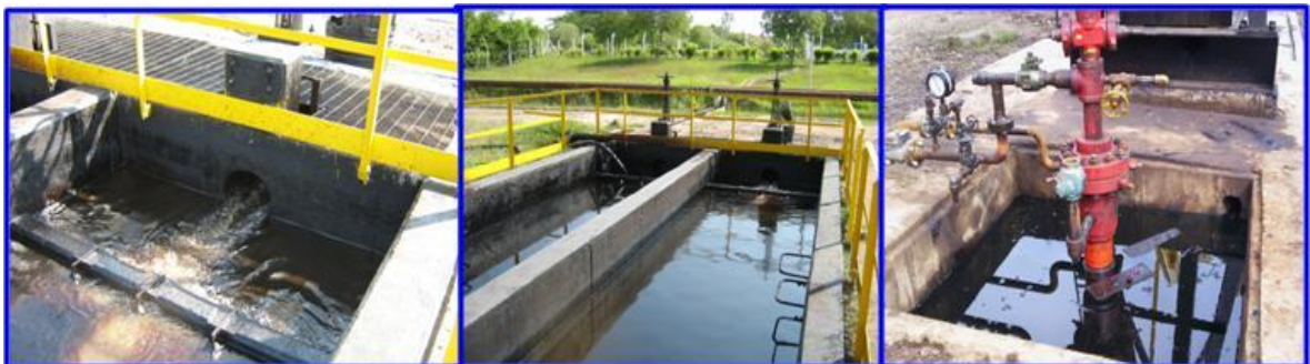
Figura 4. Separadores API, trampas de grasas y contrapozos.
