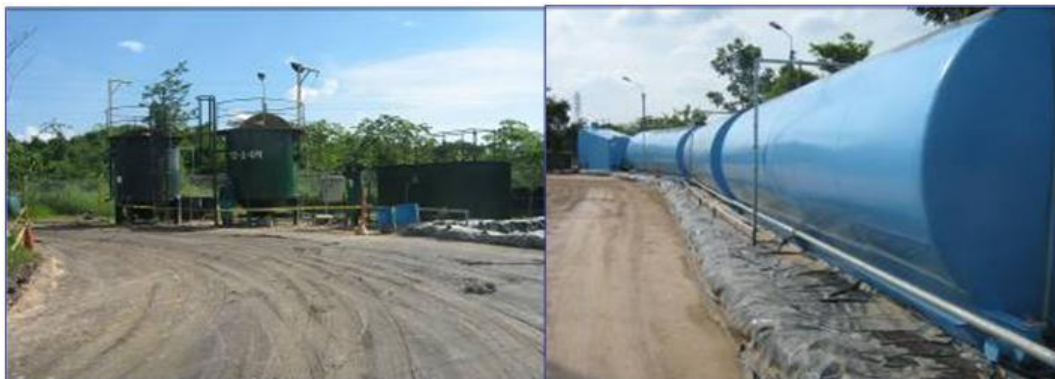
Figura 2. Unidad de tratamiento de aguas y salmueras (UTA), de la empresa contratista TWM S. A, en la antigua planta de inyección.
