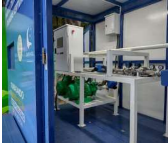
Figura 4 Visita al equipo de desinfección por cavitación instalado en vertimiento
