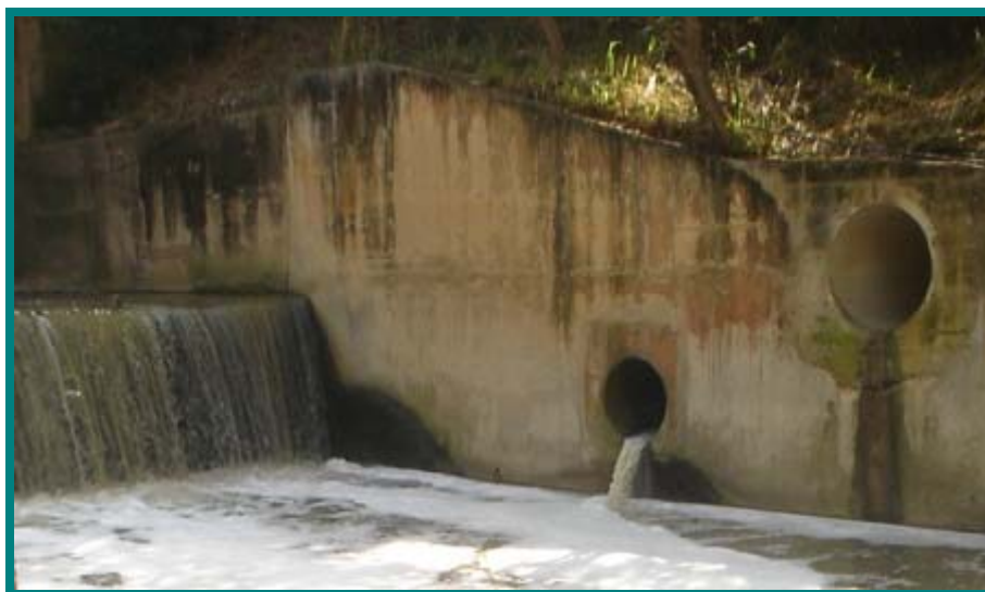
Figura 3. Conexión errada, Zona Industrial sector Quebrada La Iglesia
