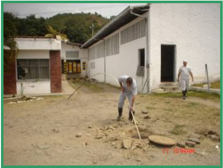
Figura 22. Localización de caja de inspección a la entrada de Distraves
