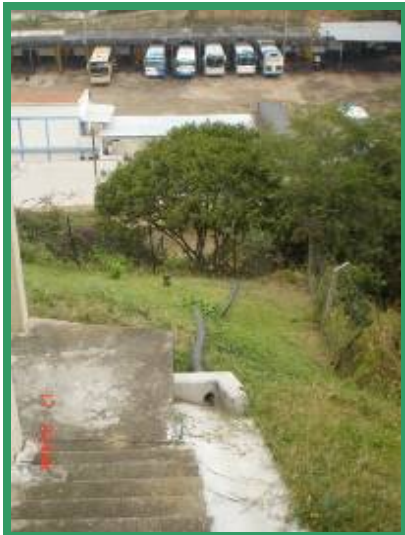
Figura 21. Drenaje de aguas lluvias Hotel San Juan
