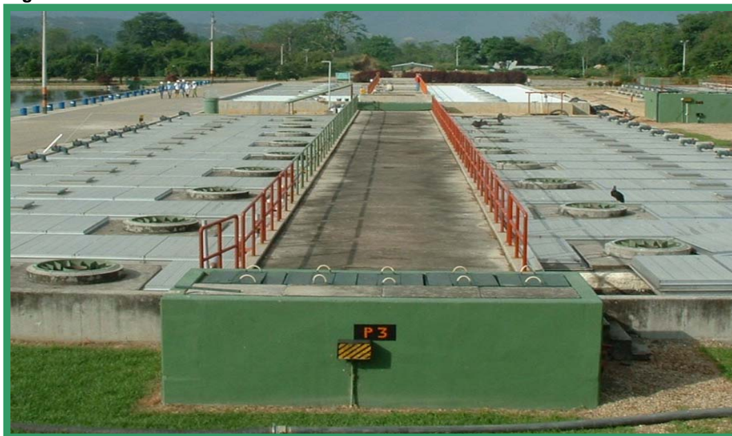
Figura 1. Panorámica del reactor No 2. Ptar Río Frío
