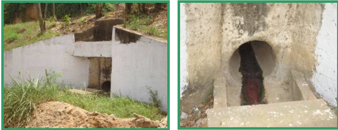
Figura 7. Box Culvert situado en la calle 57 entre cras 11 y 12 de la Zona Industrial
