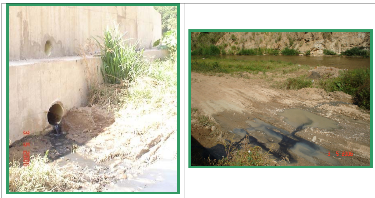
Figura 25. Descarga alcantarillado pluvial, conexión errada
