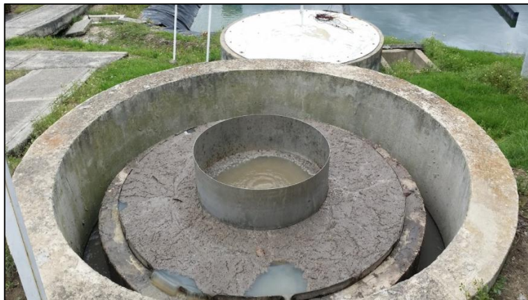
Figura 10. Sedimentador Primario PTAR de Sotaquirá
