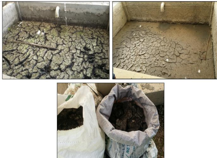
Figura 21. Lechos de Secado de la PTAR de Sotaquirá
