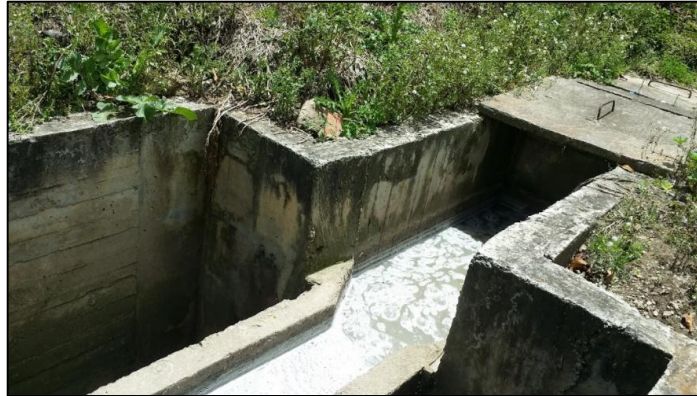
Figura 7. Aliviadero PTAR Sotaquirá
