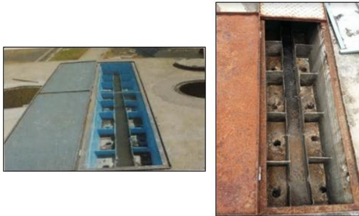
Figura 12. Reactor UASB de la PTAR de Sotaquirá
