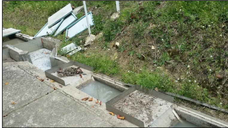
Figura 8. Canal de Cribado PTAR Sotaquirá
