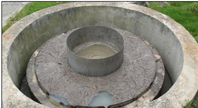
Figura 25. Material Flotante – Sedimentador Primario PTAR Sotaquirá
