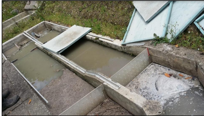
Figura 24. Material Flotante – Canal de Desarenador PTAR Sotaquirá
