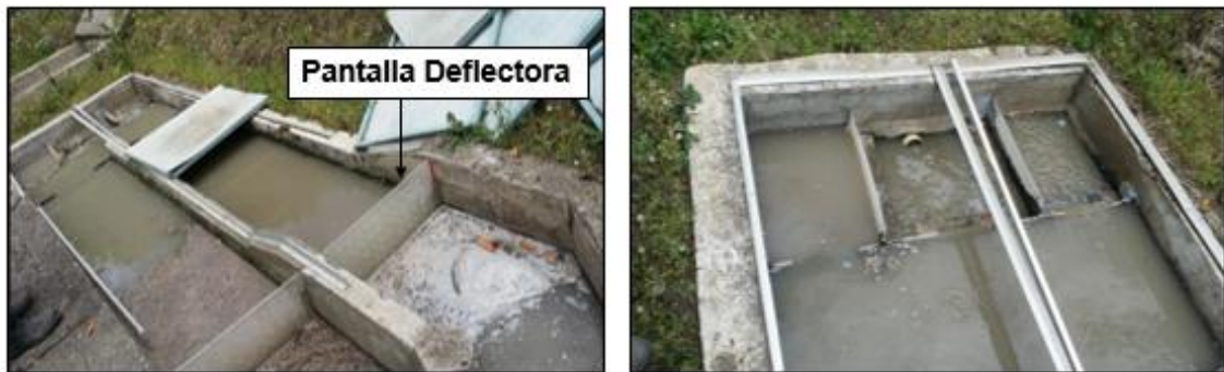
Figura 9. Desarenador PTAR de Sotaquirá
