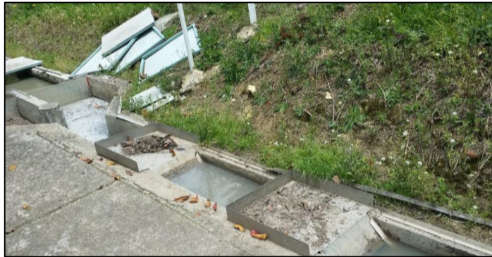
Figura 23. Material Flotante – Canal de Cribado PTAR Sotaquirá
