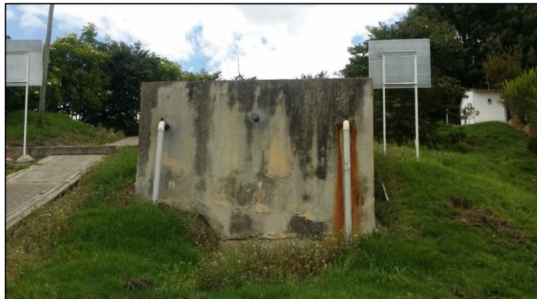
Figura 11. Tanque Imhoff PTAR de Sotaquirá
