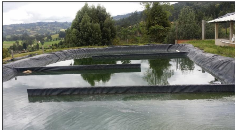
Figura 18. Laguna Facultativa de la PTAR de Sotaquirá
