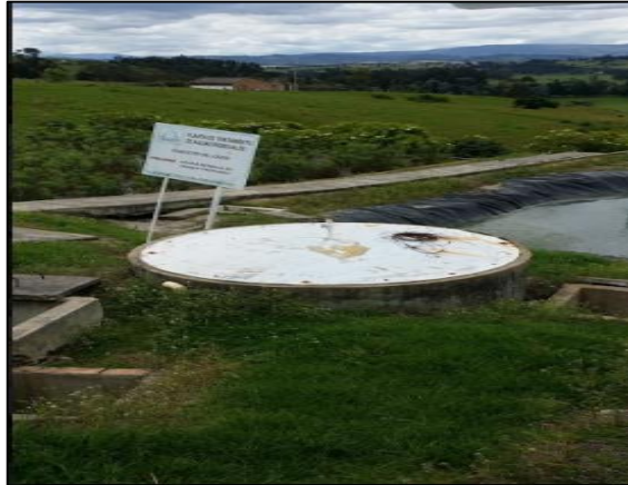
Figura 20. Digestor de lodos de la PTAR de Sotaquirá
