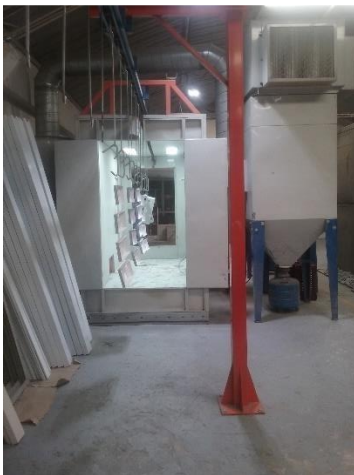
Figura 12. Área de pintura.
