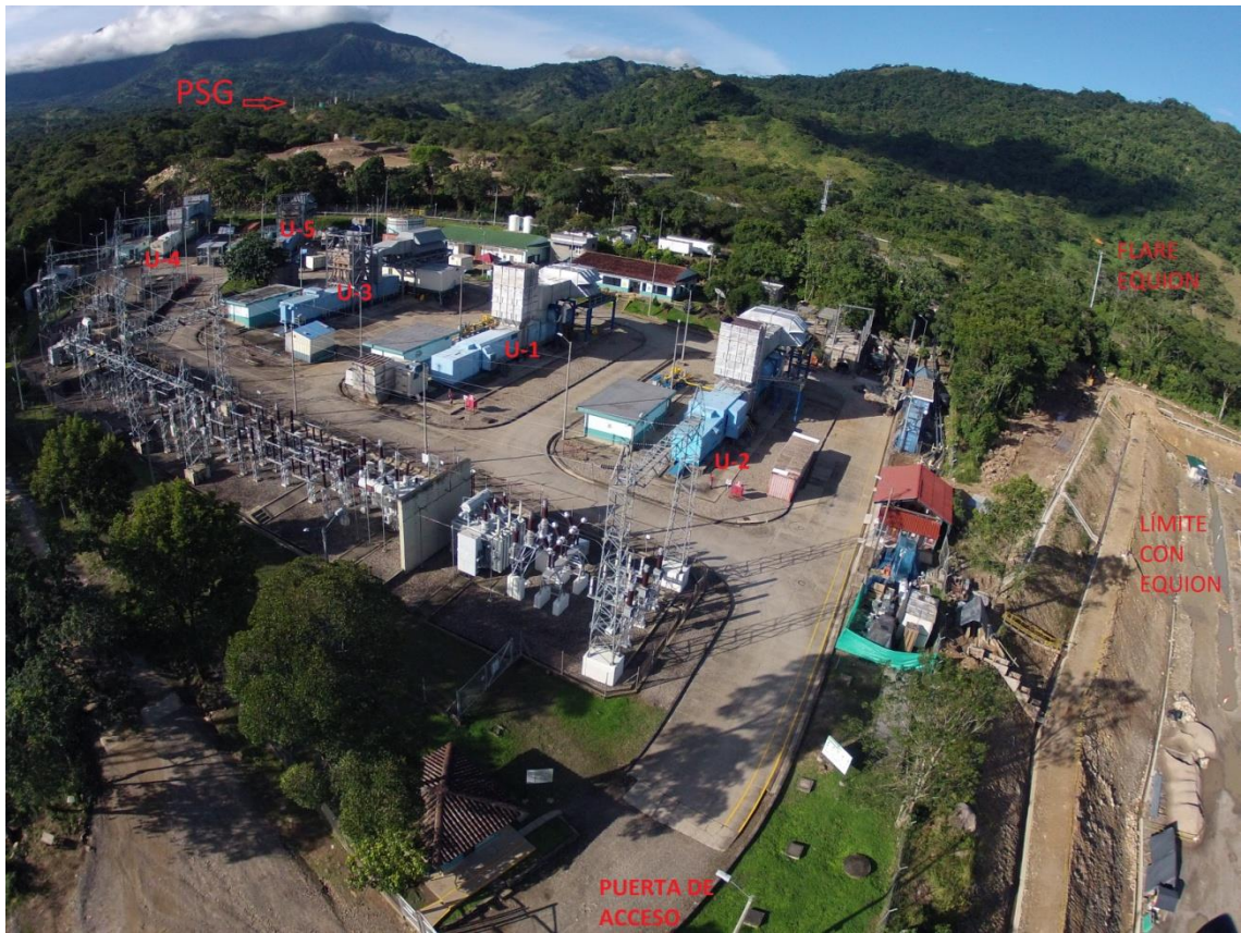
Figura 2. Planta Termoyopal Generación y sus cinco unidades de generación de energía. (Autor)
