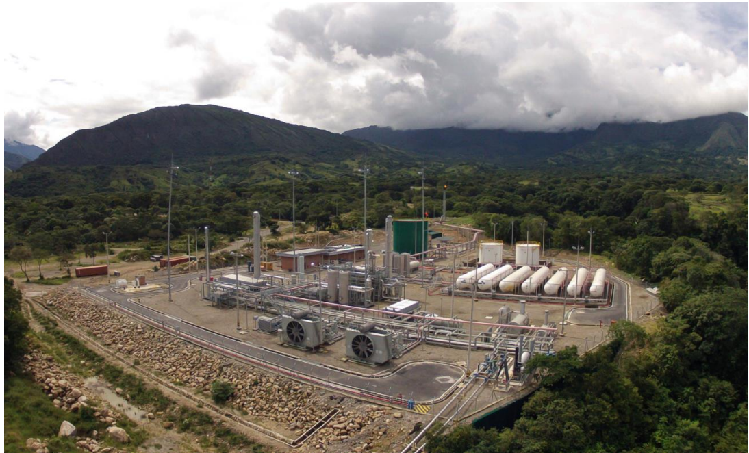
Figura 4. Planta de Secado de Gas de Termoyopal. (Autor)
