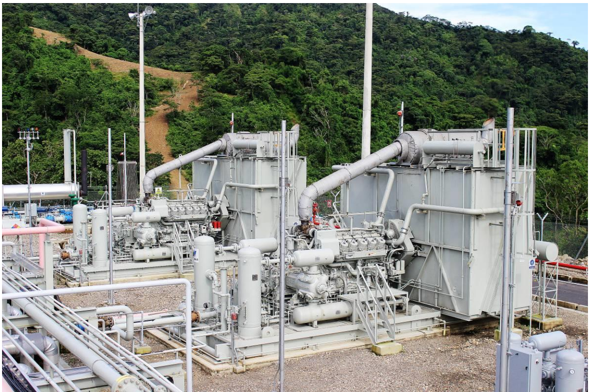
Figura 10. Compresores recíprocos (C-1100 y C-1200) con motores a gas Waukesha de 20 MMSCFD c/u.
