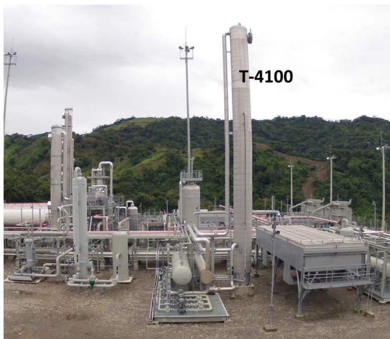
Figura 17. Torre DesButanizadora de fraccionamiento de gas en PSG.
