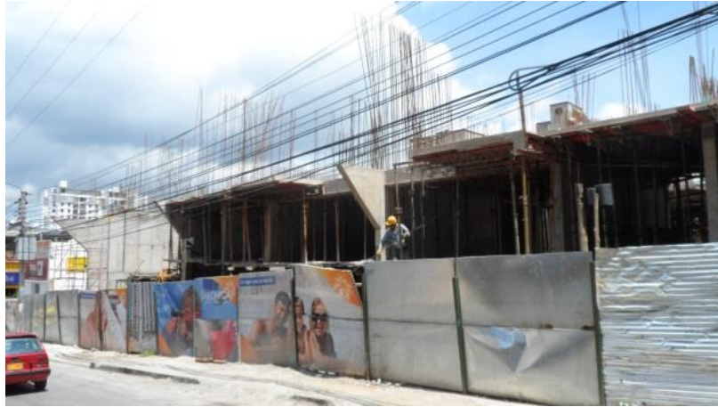
Figura 10. Fotografía actual del proyecto Salónica sobre la calle 34.
