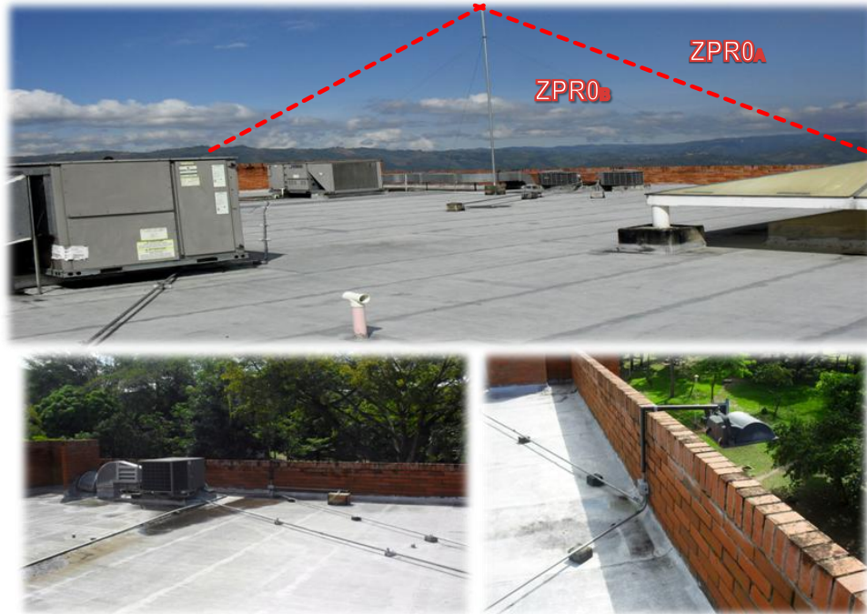
Fotografía 3 Elementos presentes en la azotea del edificio y protegidos en la subzona ZPRO B
