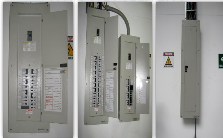
Fotografía 7 Tableros planta subsótano y planta primer piso
