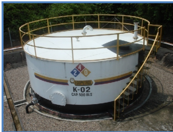
Fotografía 9 Vista General del Tanque K - 02, Campo Escuela Colorado
