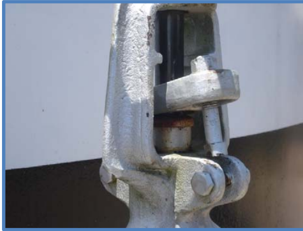
Fotografía 5 Válvula de entrada de crudo Tanque K – 01.
