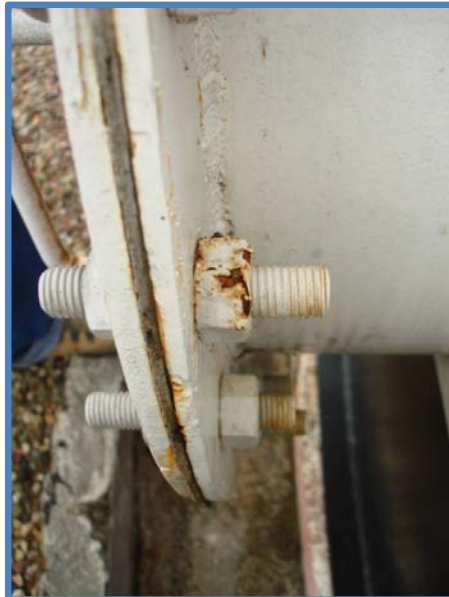
Fotografía 6 Tornillos del Man hole tanque K – 02
