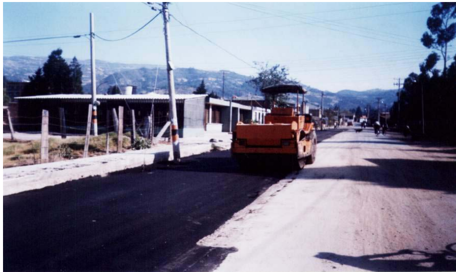
FOTO 13. Pavimentación vía Monquirá. Compactación con vibro compactador de la mezcla asfáltica tipo rodadura.
