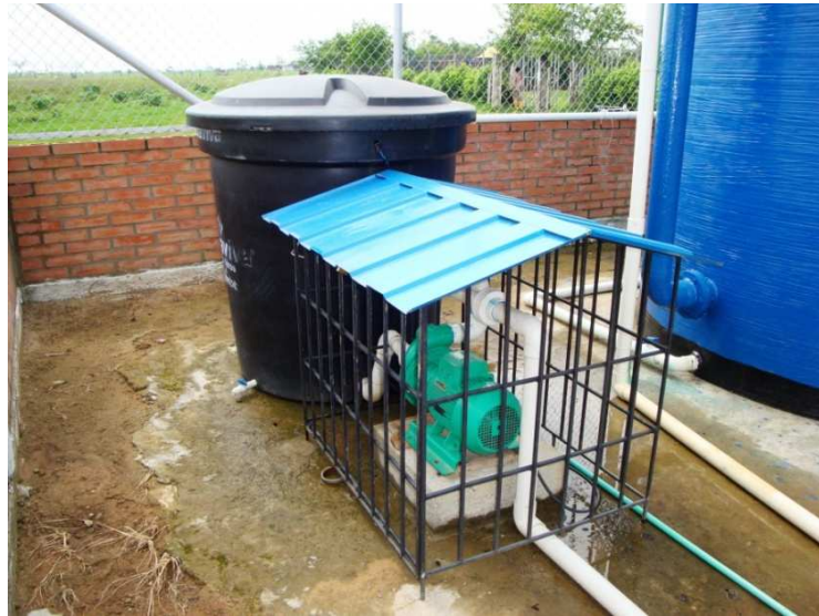
Figura 6. Sistema de rebombeo de agua tratada
