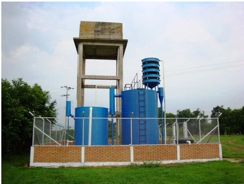
Figura 5. Vista General de la PTAP FLUIPACK de la vereda Palo Solo
