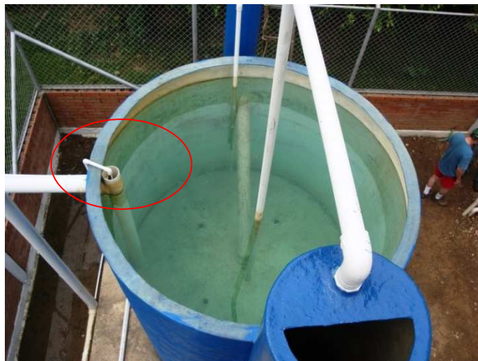
Figura 12. Punto de aplicación del hipoclorito de sodio
