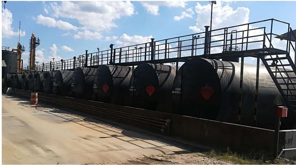
Figura 22. Tanques de almacenamiento de crudo para los campos Corcel.
