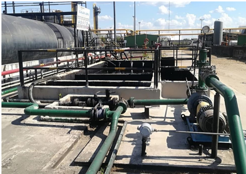
Figura 26. Cajas API CPF Corcel.
