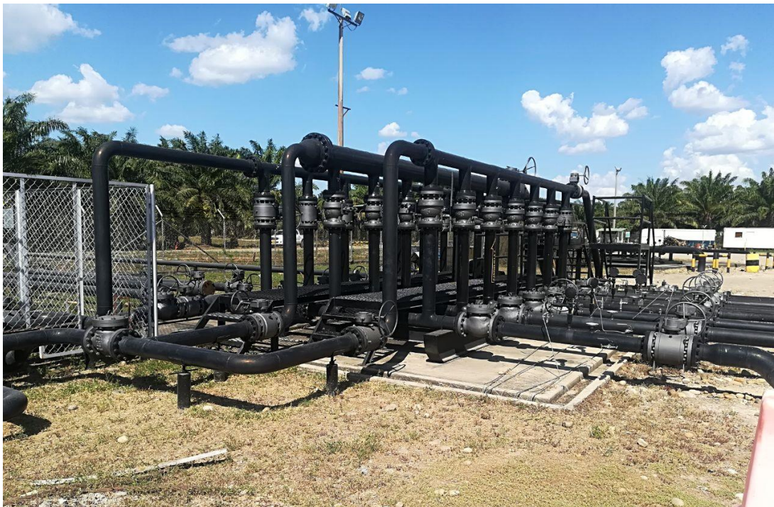
Figura 7. Manifold de producción en locaciones
