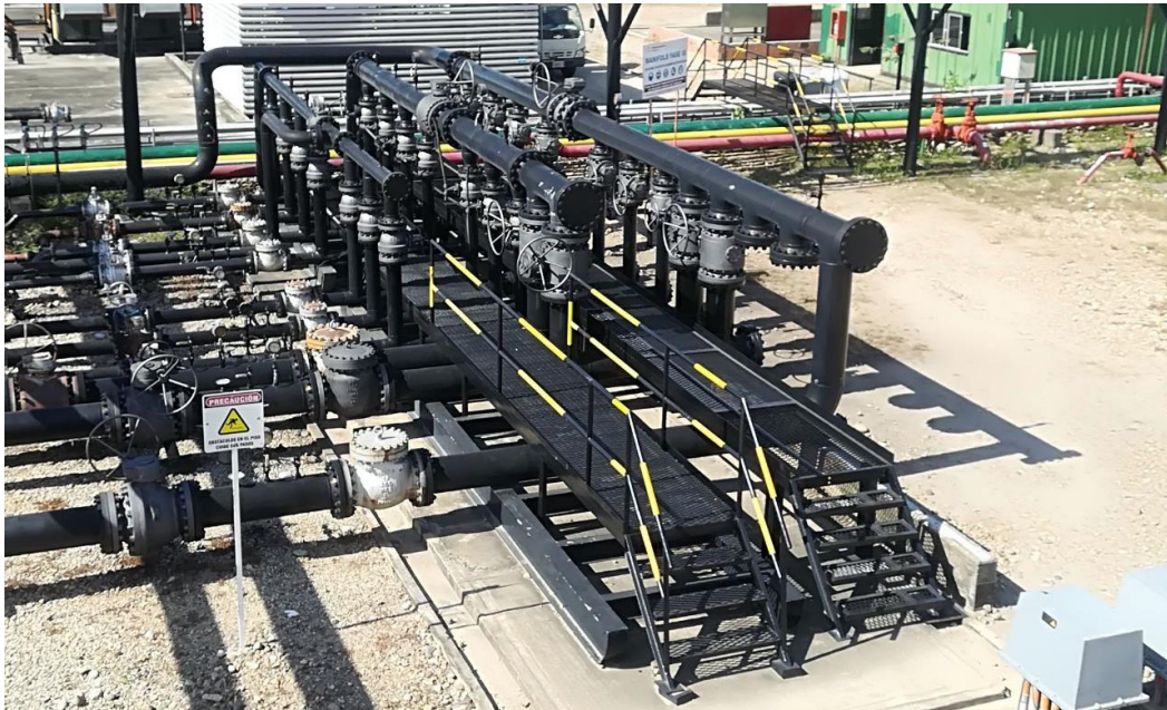
Figura 13. Manifold de recibo CPF Corcel.
