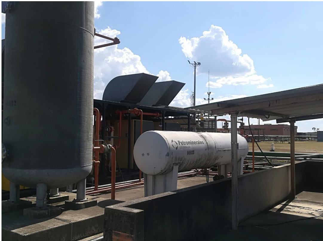
Figura 27. Compresores aire de instrumentos CPF Corcel.
