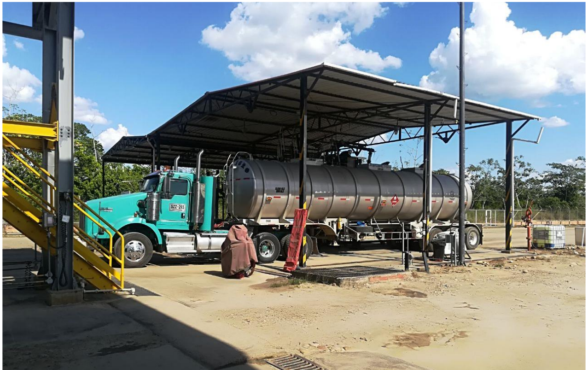
Figura 25. Cargadero de crudo en tracto camiones en el CPF Corcel.
