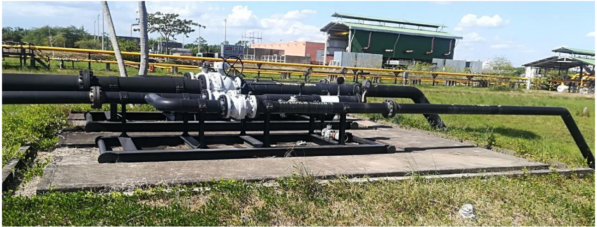
Figura 12. Trampas de lanzamiento y recepción de raspadores.
