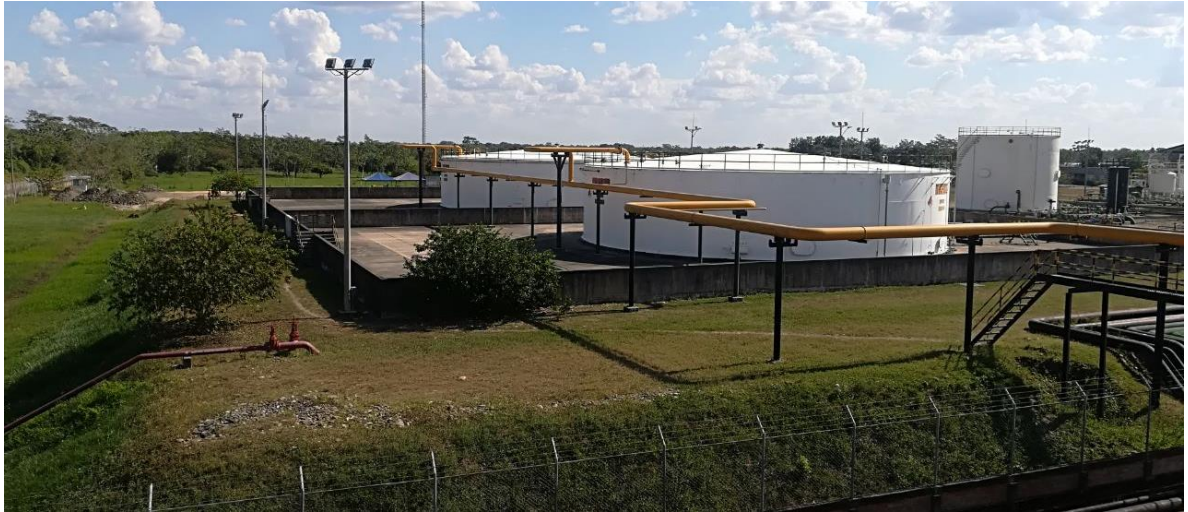
Figura 23. Tanques de almacenamiento de crudo para los campos Candelilla, Yatay, Avispa, Ceibo y Ardilla.
