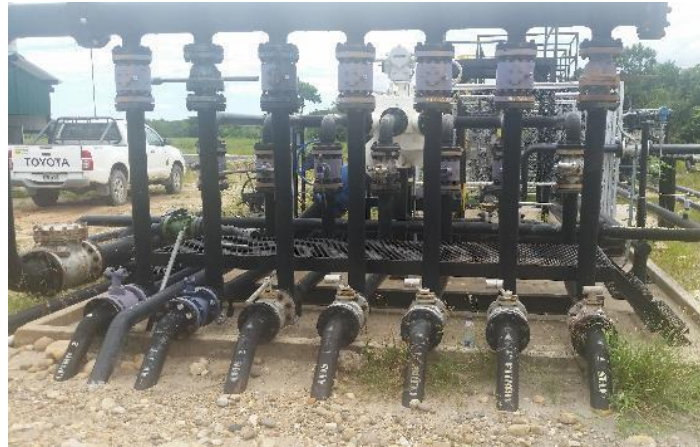
Figura 11. Manifold y válvulas selectoras multipuerto locación Ceibo.
