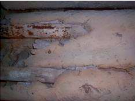
Figura 37. Daños del MCO-T en las líneas de Fuel oil y Acpm hacia los intercambiadores
