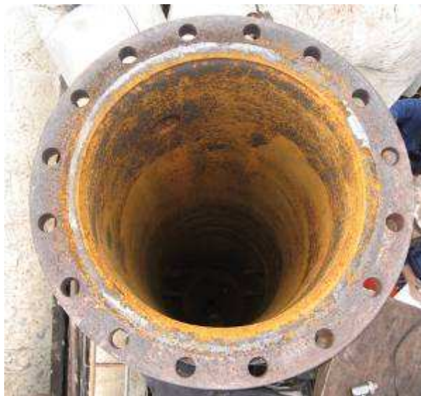
Figura 30. Estado del la brida de la Despojadora D2
