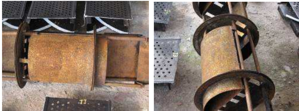
Figura 35. Estado de los internos Despojadora D3
