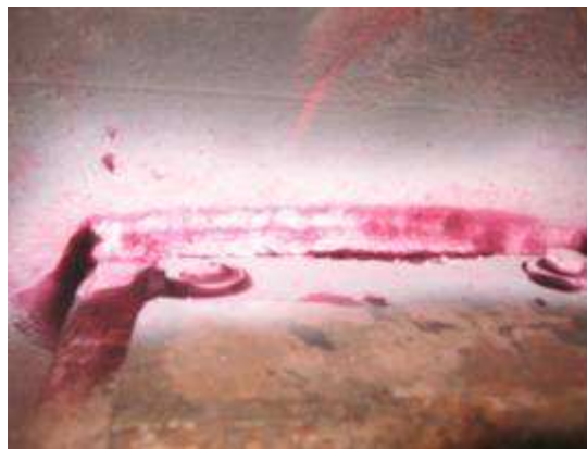
Figura 46. Estado actual de la soldadura correctiva de la grieta reparada
