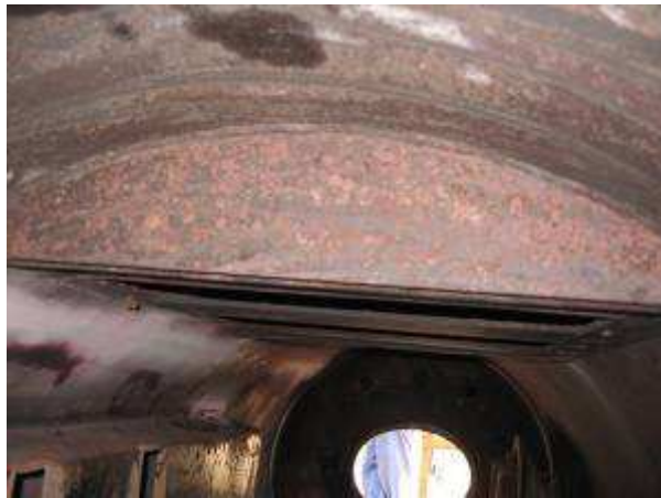
Figura 13. Accesorio de la cámara de secado en el domo de vapor
