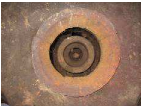
Figura 8. Fotografía de uno de los quemadores del horno F1
