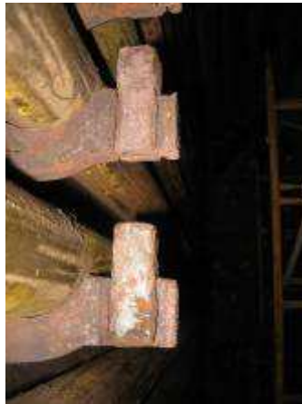
Figura 19. Soportes y Cuñas con Presencia de Sulfidación
