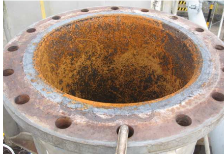
Figura 33. Estado de la brida en la despojadora D3
