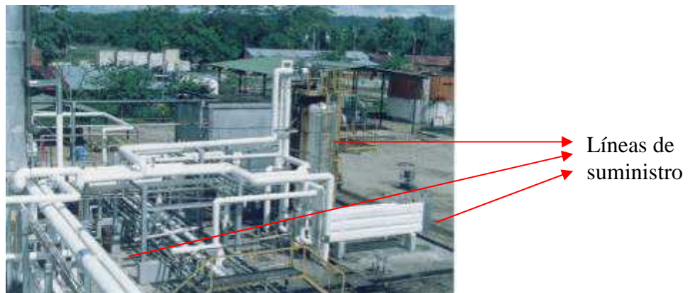
Figura 15. Líneas de Suministro en la Refinería
