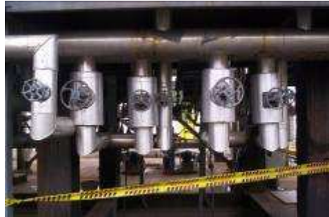
Figura 9. Suministro de vapor y combustible a los quemadores
