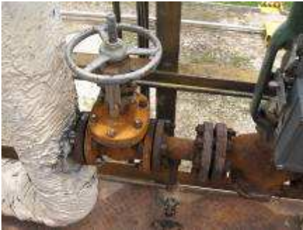
Figura 38. Estado del MCO-T cerca de las bridas de alimentación del domo de vapor
