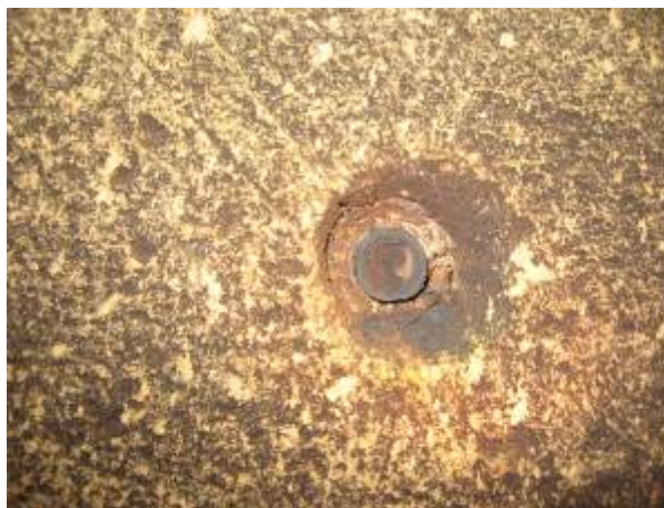
Figura 22. Termopozo en pared de zona de radiación
