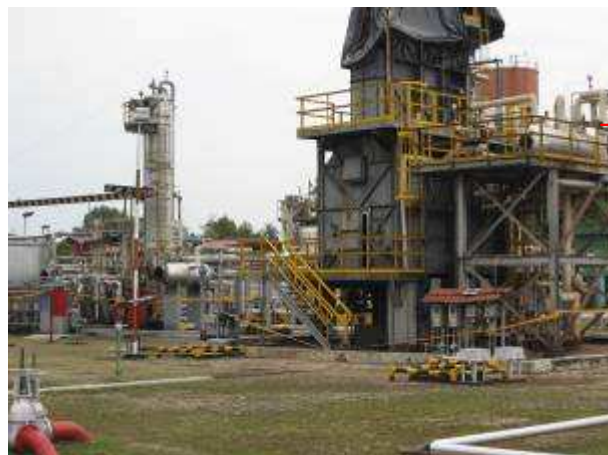
Figura 16. Fotografía del horno y el tambor de vapor
