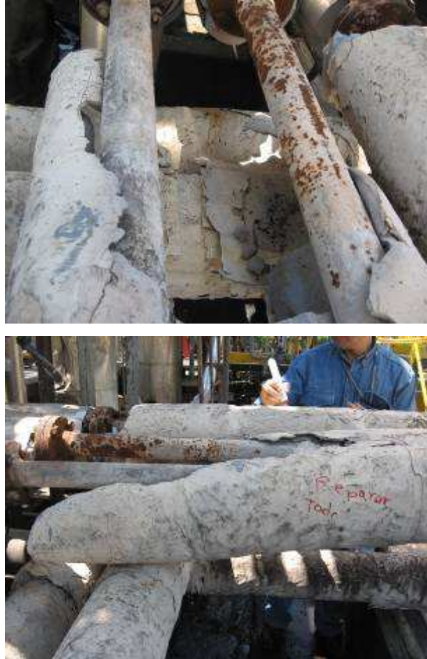
Cuadro 2. Resumen de las fallas encontradas en la inspección basada en el RBI.
