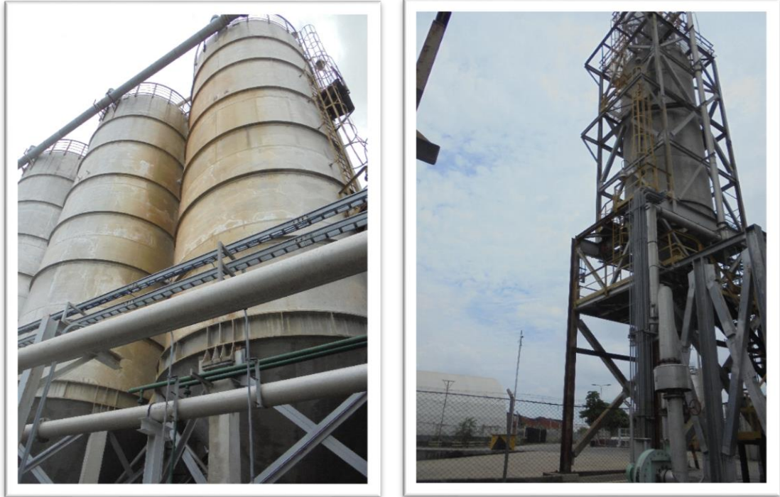
Figura 19. Tolvas de almacenamiento y de despacho a granel
