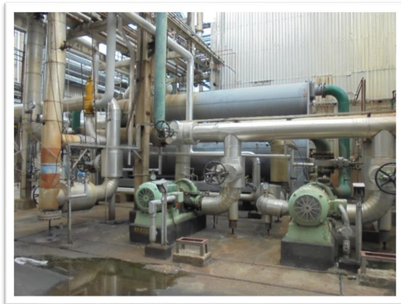
Figura 8. Unidad de refrigeración por absorción ARU
