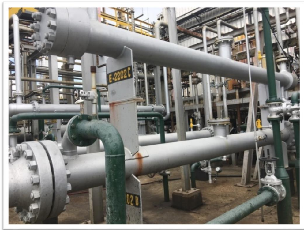
Figura 6. Intercambiadores de calor inter-etapas (compresión baja)
