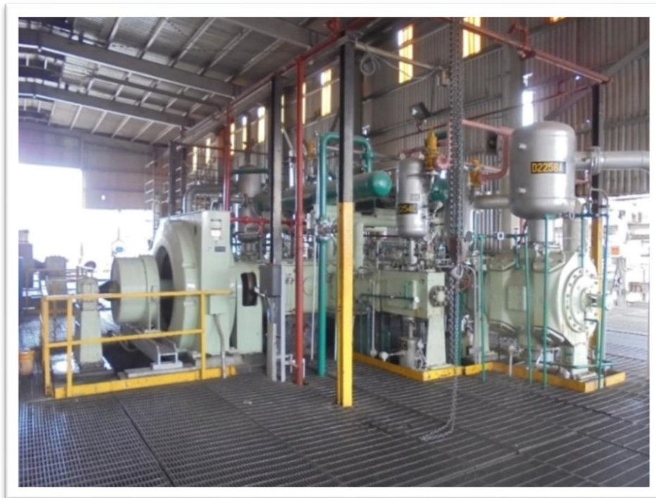
Figura 5. Compresor recíproco (primario) Polietileno II
