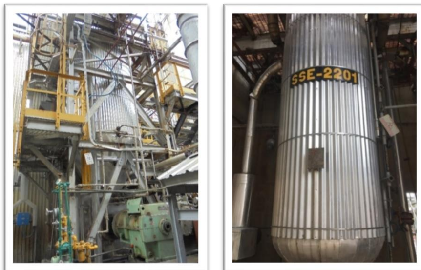
Figura 11. Separador de baja presión y de alta presión
