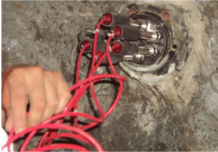
Detalle de transductores de desplazamiento instalados en extensómetro de posición múltiple.
