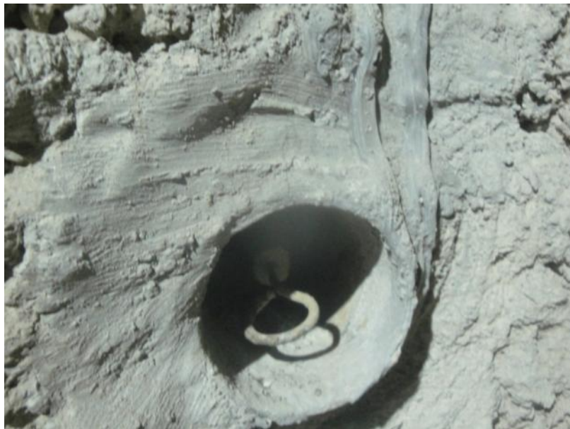
Figura 20. Aspecto de Argolla de convergencia instalada.
