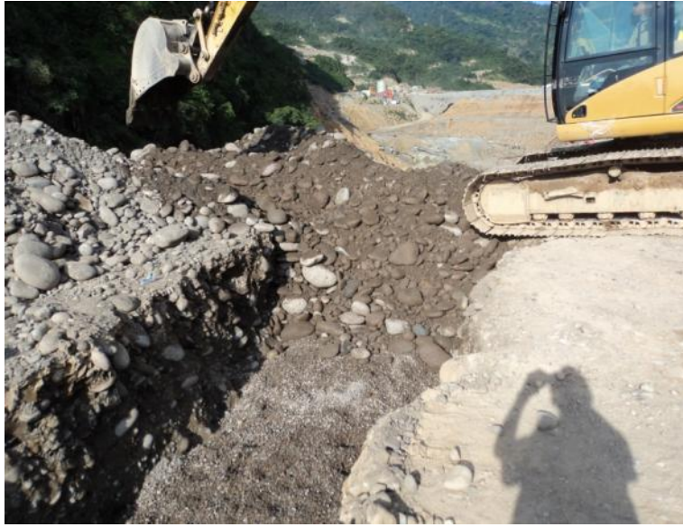
Finalización del relleno de la zanja con material relleno de la presa.
