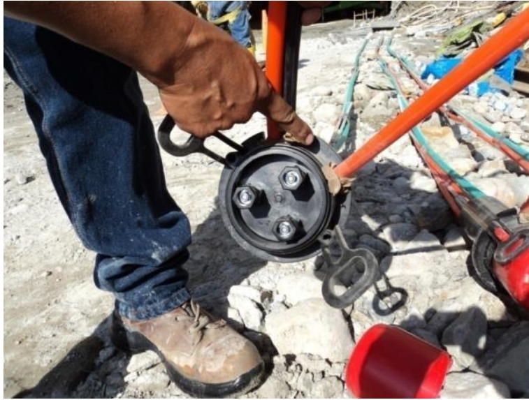
Detalle de las salidas a los transductores del extensómetro de posición múltiple.
