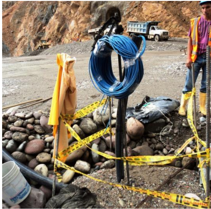
Cableado del piezómetro de hilo vibrátil en la superficie para lectura manual.
