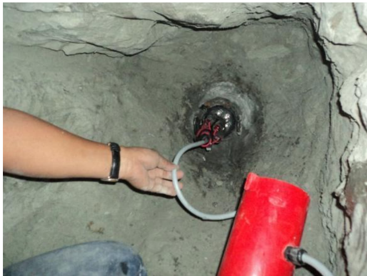
Transductores de desplazamiento instalados en extensómetro de posición múltiple.
