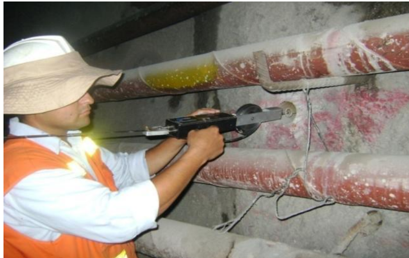
Lectura de argollas de convergencia con extensómetro de cinta.
