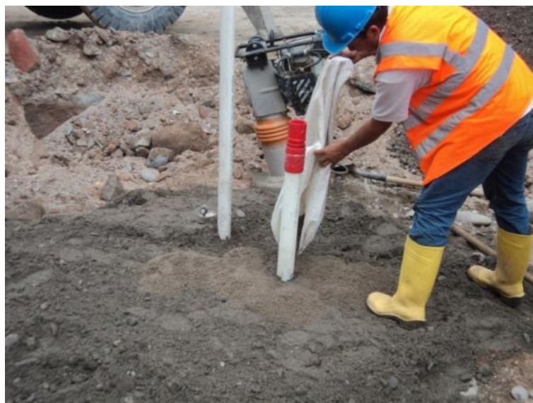
Preparación del terreno para instalación de la placa magnética del sistema Dex-Brs.
