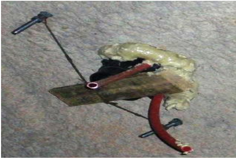
Extensómetro anclado a la superficie del túnel.
