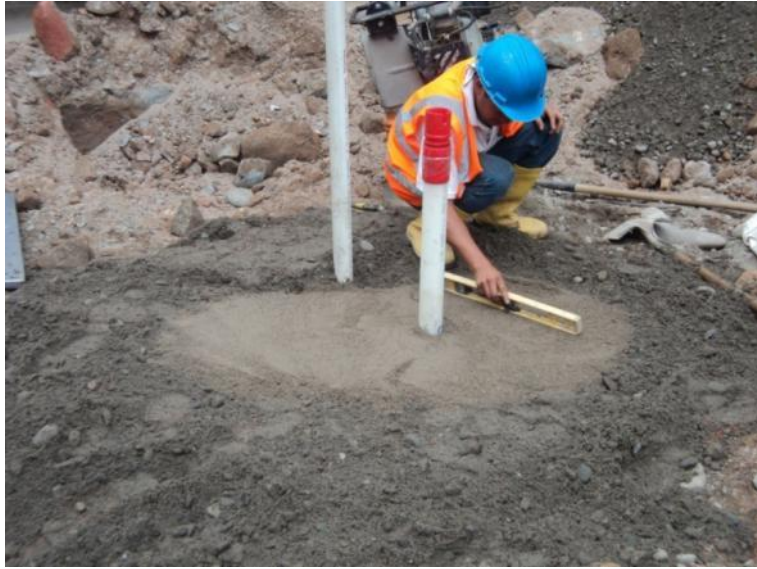
Nivelación del terreno para instalación de la placa magnética del sistema Dex-Brs.
