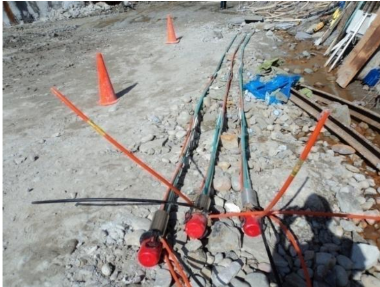
Figura 23. Apariencia del extensómetro de posición múltiple antes de su instalación.
