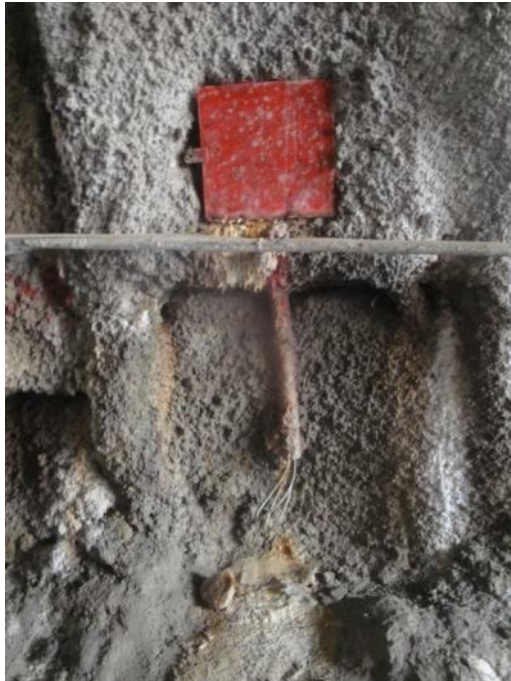
Caja de protección para el extensómetro de posición múltiple.
