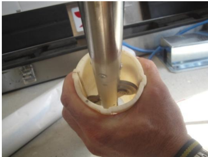
Detalle tubería ABS
