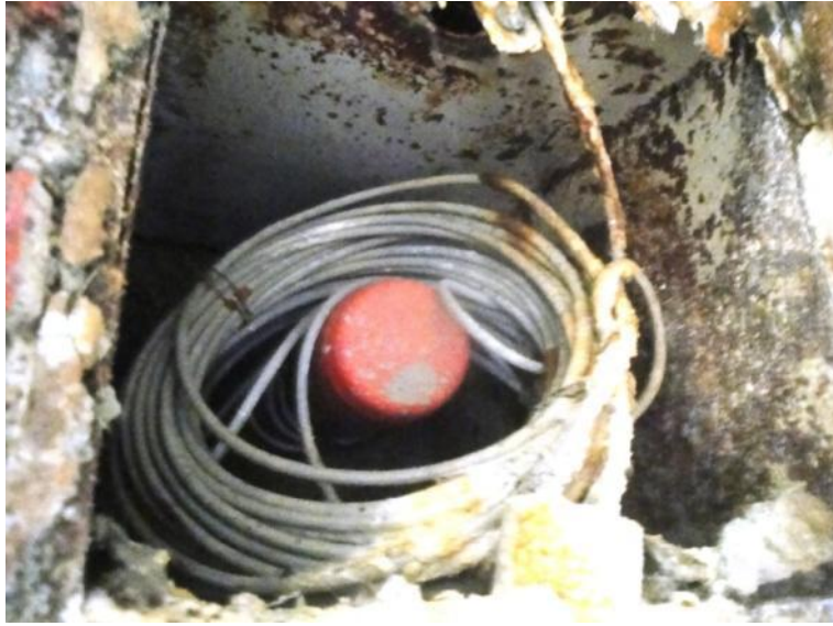
Detalle del interior de la caja de protección.
