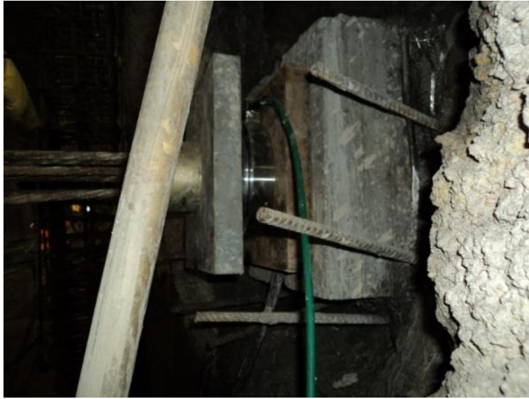
Detalle de la celda de carga.
