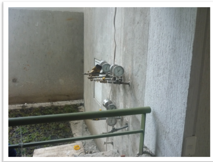
Figura 25. Manómetros Instalados para prueba de Hermeticidad
