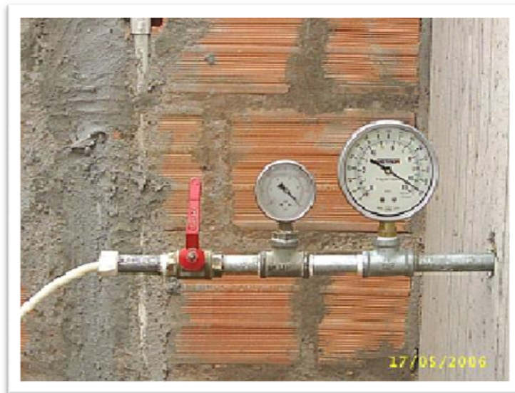
Figura 16. Verificación de manómetros
