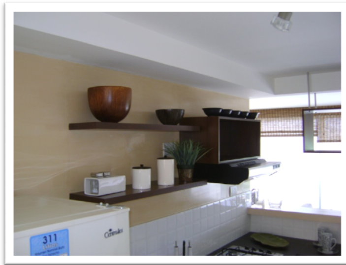
Figura 7. Detalle Cielo raso cubriendo bajantes en la cocina.
