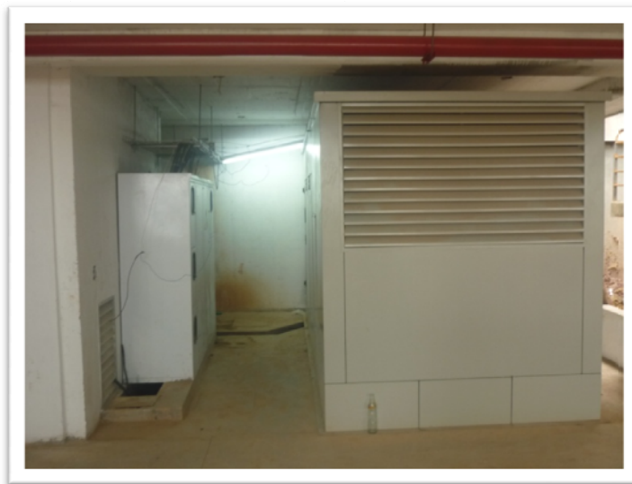
Figura 10. Planta eléctrica Tayrona 1.
