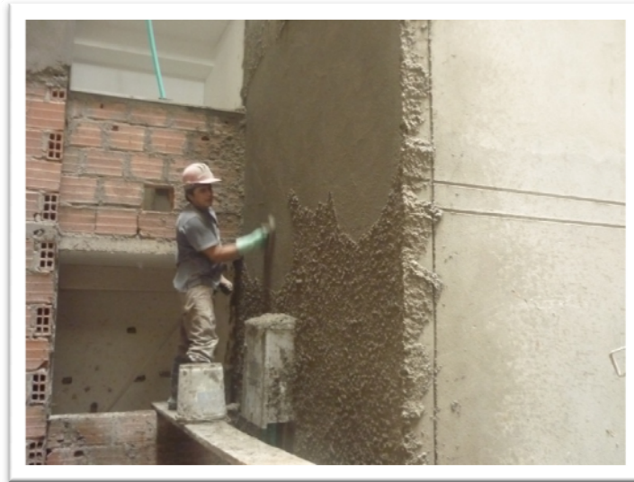
Figura 4. Pañete sobre muro exterior
