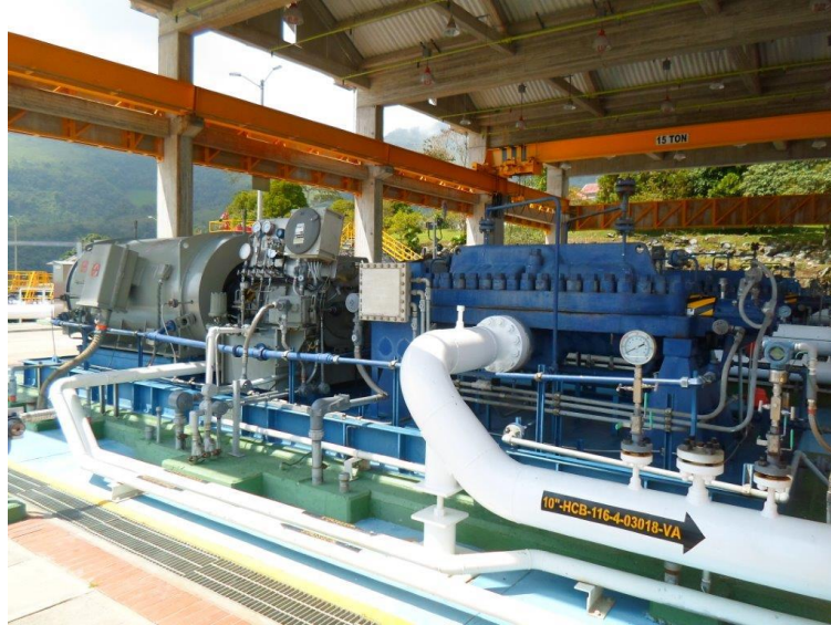
Imagen 1. Unidad principal BPC 8410. Estación de Bombeo Santa Rosa
