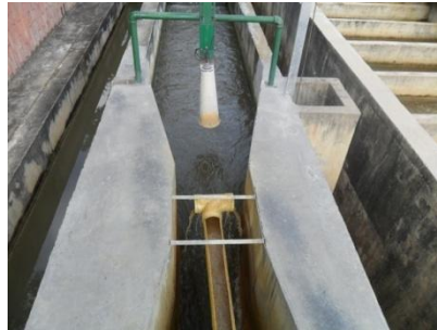
Figura 2. Medición por caudalímetro de ultrasonido
