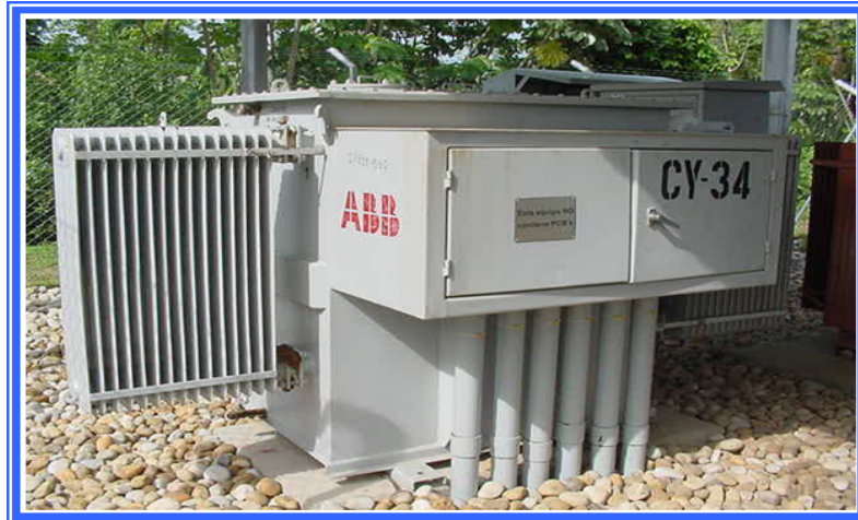
Figura 6. Transformador elevador (SUT)
