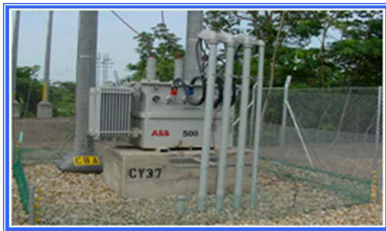
Figura 5. Transformador reductor (SDT).
