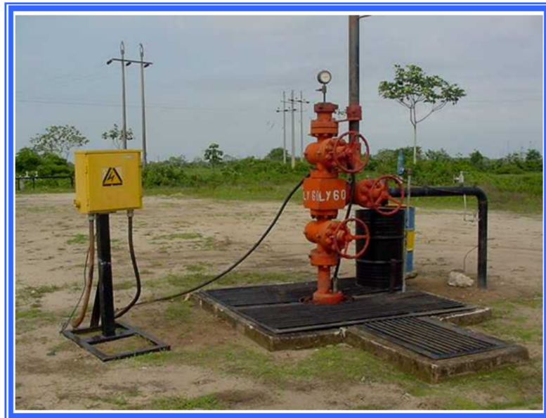
Figura 9. Cabezal de pozo.
