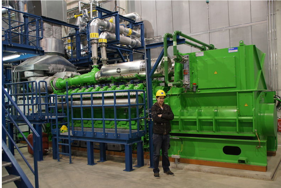
Figura 11. Motores a gas en la generación eléctrica
