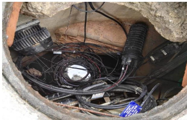
Figura 34. Cámara totalmente desordenada.
