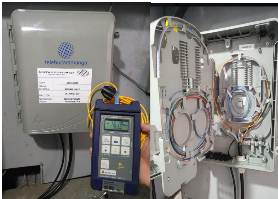
Figura 22. NAP Indoor con prueba de potencia instalada en Edificio Vicenza, barrio Cabecera.
