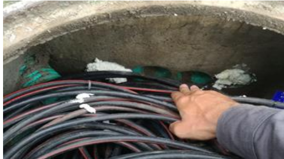
Figura 36. Espuma de polietileno en tuberías.
