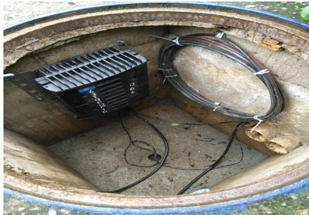
Figura 33. FDP y fibra correctamente instalada en cámara.
