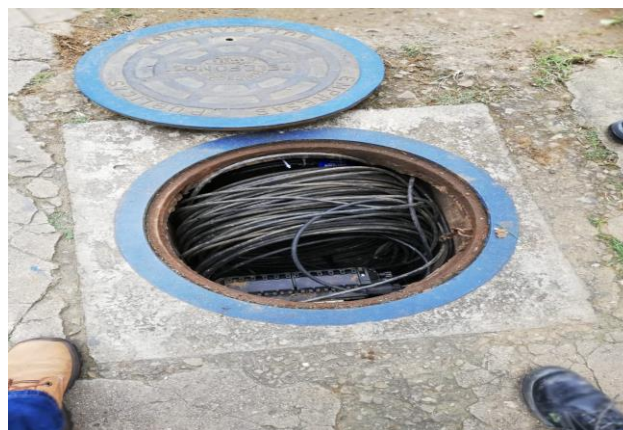
Figura 35. Cámara demasiado llena.
