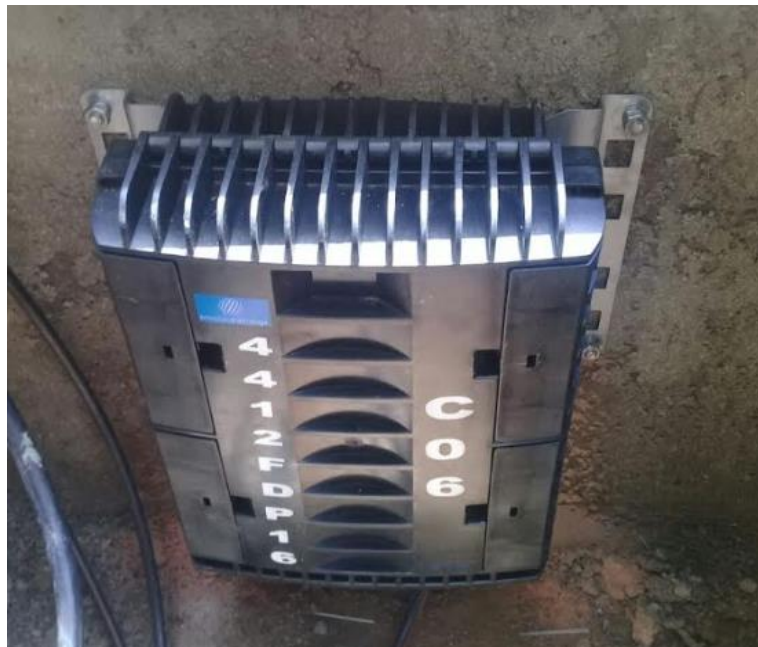
Figura 20. FDP instalada en el barrio Ciudadela.
