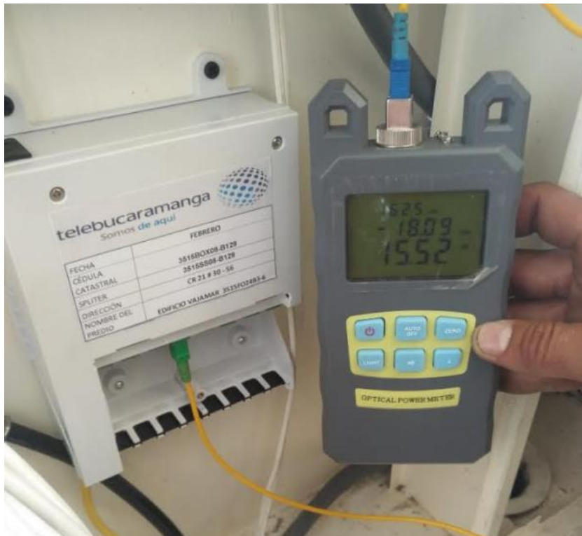
Figura 23. Riser BOX con prueba de potencia instalada en Edificio Vajamar, barrio Antonia Santos.
