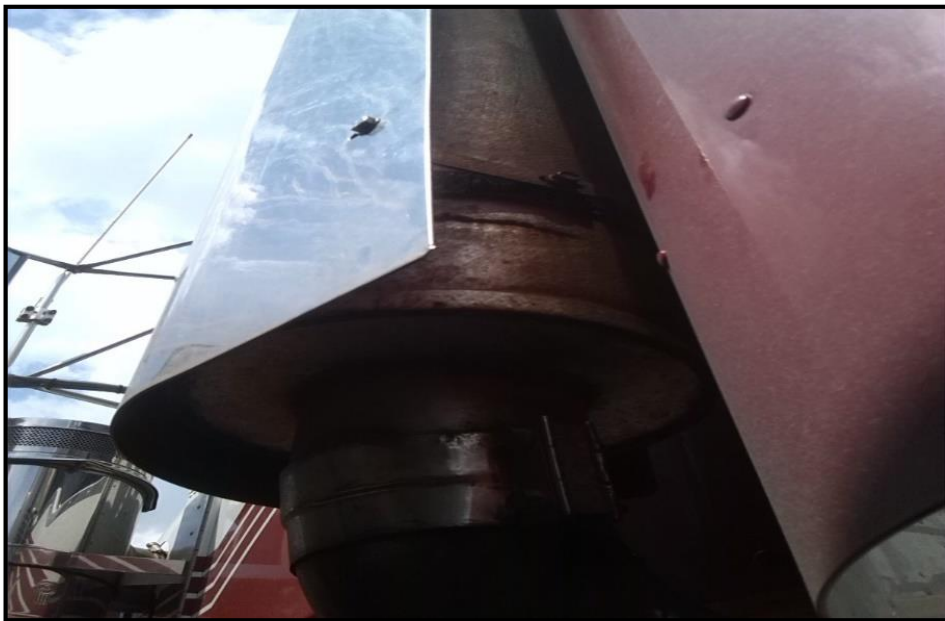
Figura 51. Falla de tubería de escape
