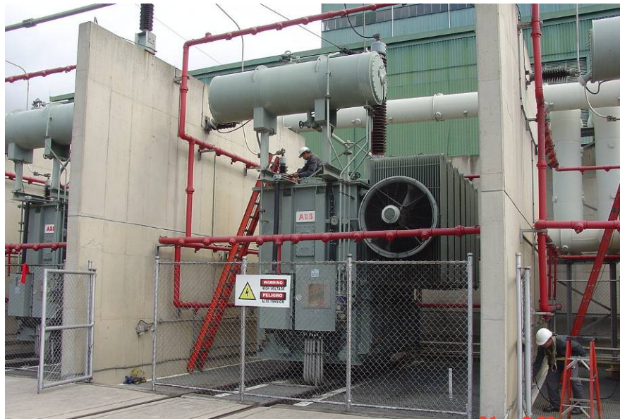
Figura 19. Transformador monofásico principal - Termopaipa IV.
