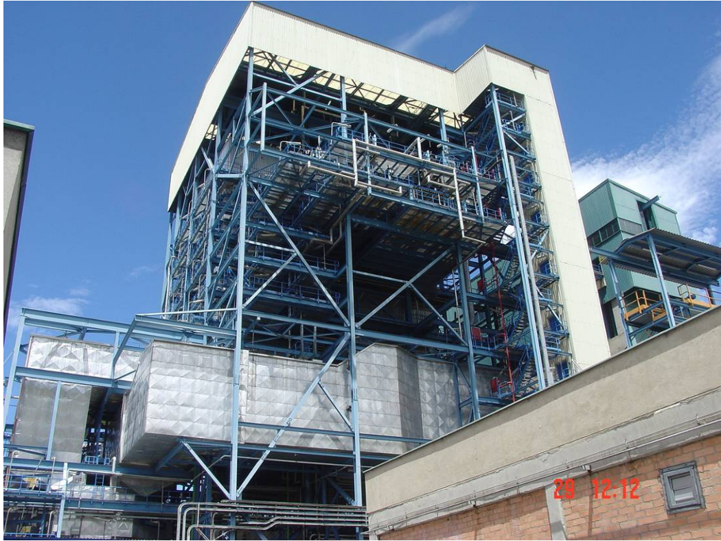
Figura 14. Vista caldera de la planta Termopaipa IV.
