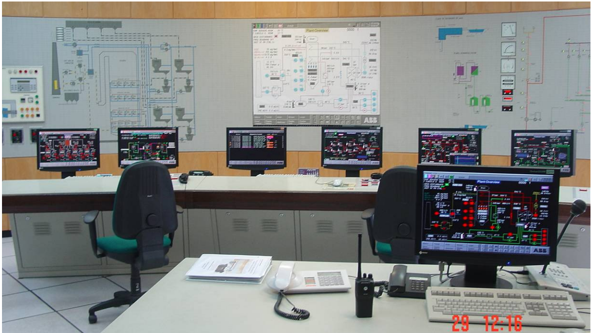
Figura 24. Sala de Control Termopaipa IV.
