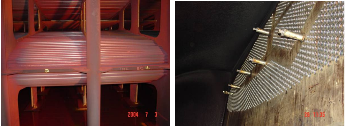
Figura 21. Condensador Termopaipa IV: 1 – Lado vapor, 2 – Lado agua.
