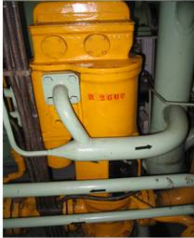
Foto 12. Válvula de regulación de gas.
