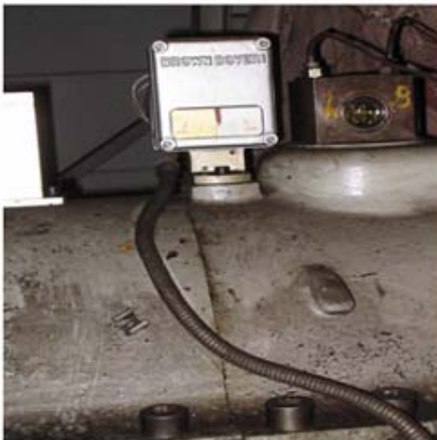
Foto 14. Medidor de desplazamiento axial.
