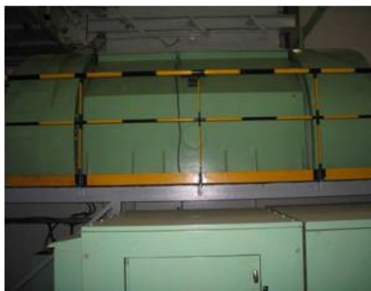
Foto 7. Generador o alternador.
