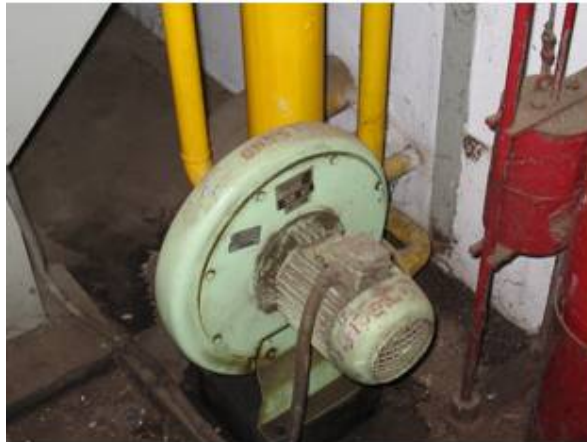
Foto 13. Ventilador de aspiración de fuga de gas.
