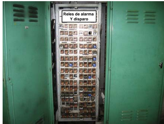
Foto 17. Gabinetes de control de la Unidad N°3.
