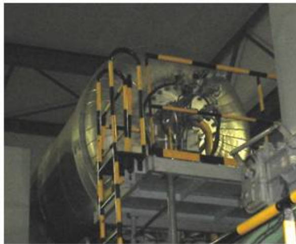
Foto 5. Cámara de combustión.
