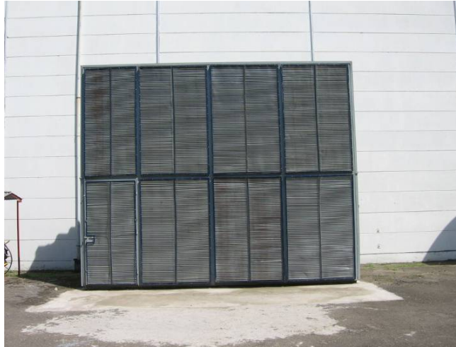
Foto 4. Filtros de aire del compresor.
