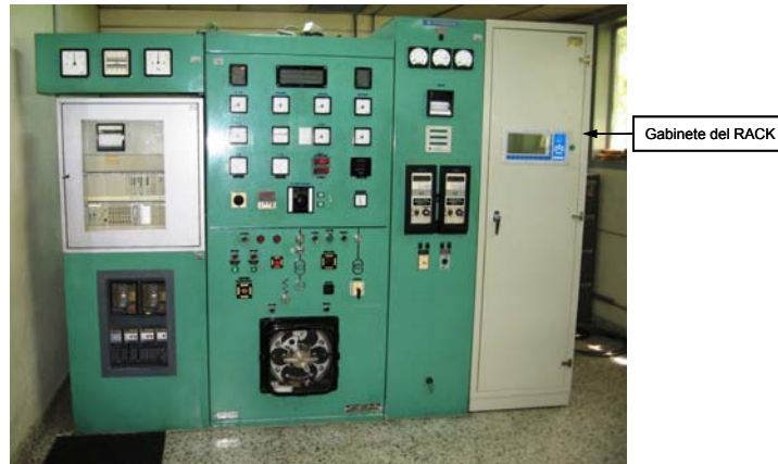
Foto 15.Ubicación del gabinete del RACK 3500.
