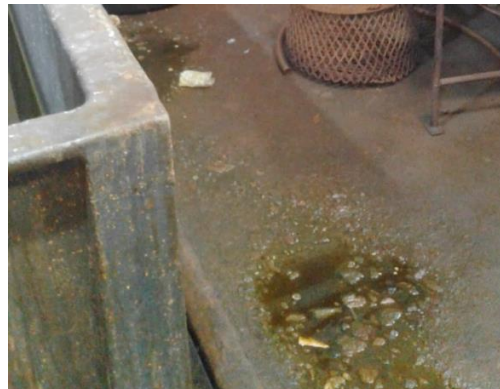
Figura 11. Líquido residual en el área de decapado/fluxado.
