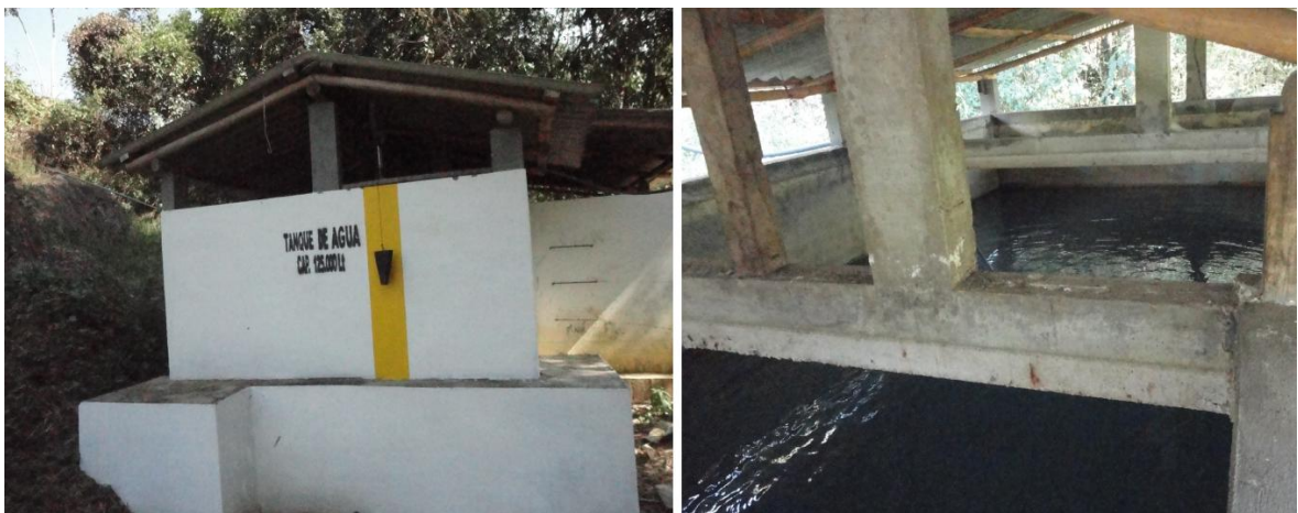
Figura 30. Tanque de almacenamiento de agua, capacidad de 125 m 3 .
