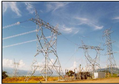
Figura 29. Subestaciones eléctricas Fuente: Ministerio de Minas y Energía
