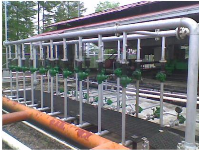
Figura 47. Manifold de entrada de pozos Estación Bonanza 2009
