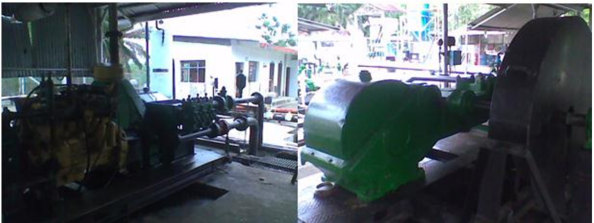
Figura 51. Bombas de despacho B1 y B2 Estación Bonanza 2009
