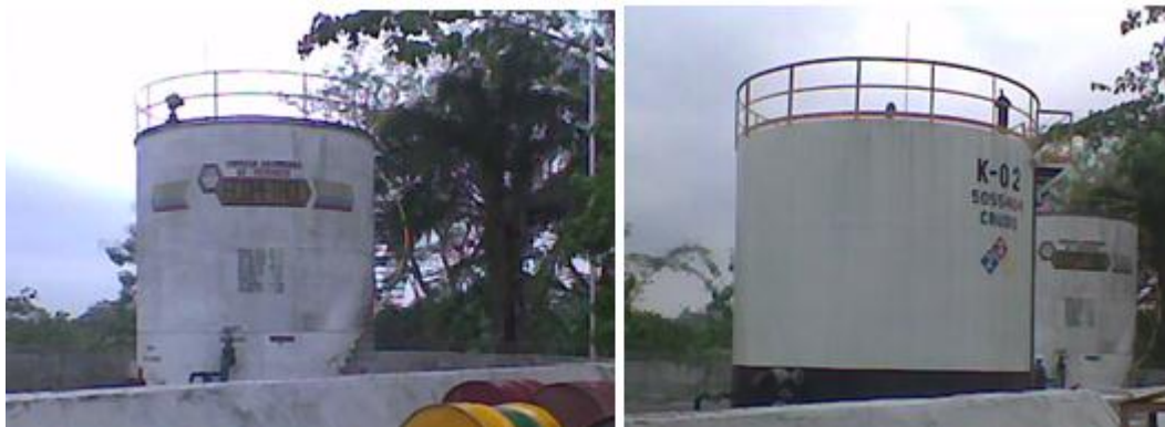
Figura 50. Tanques de recibo/despacho K01 y K02 de 1000 BPD Estación Bonanza 2009
