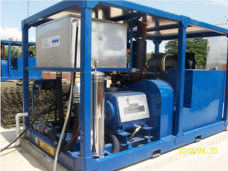
Figura 2. Equipo (Bomba de alta presión)
