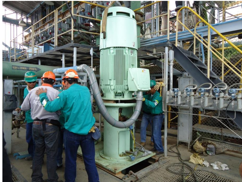
Figura 7. Conjunto motor bomba P-801-Q
