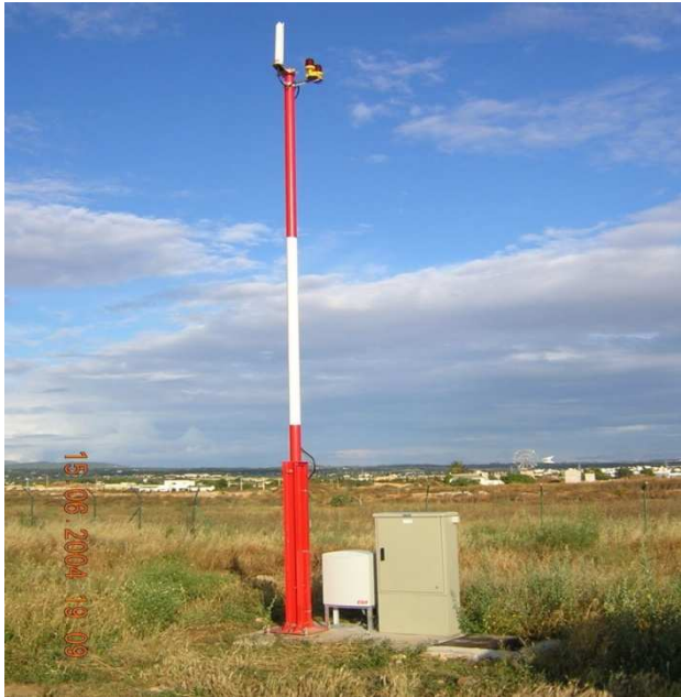
Figura 6. Estación receptora con enlace de datos fibra óptica
