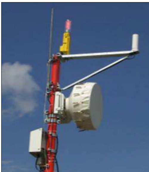
Figura 5. Estación receptora con enlace de datos microondas
