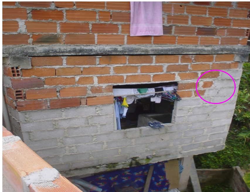
Figura 4-7 Nótese el pegue entre ladrillos y el no confinamiento.
