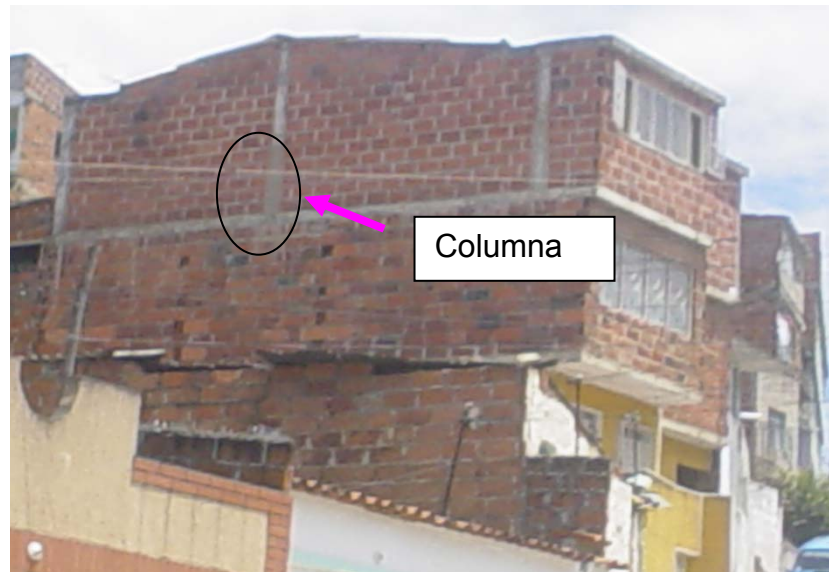
Figura 4-2 Pisos inferiores sin amarre estructural.
