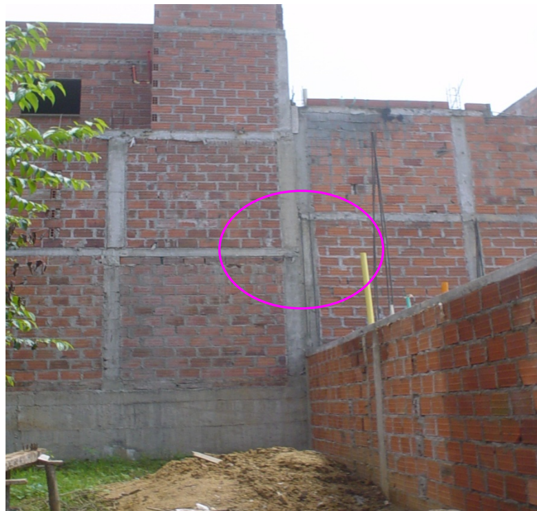
Figura 4-17 Ver delta de altura entre losas vecinas.
