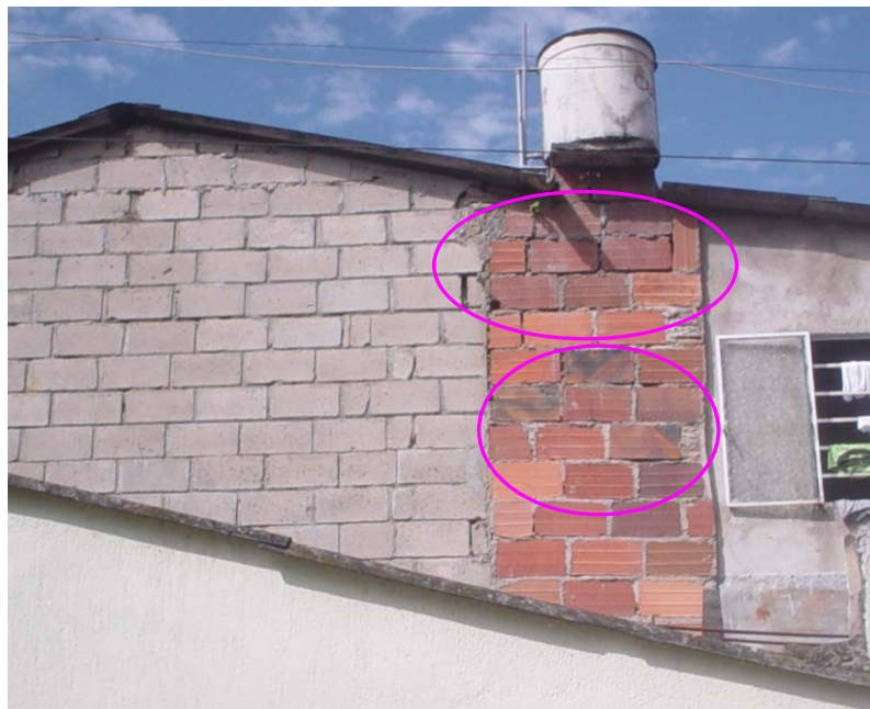
Figura 4-14 Vea la mala distribución del ladrillo H-10 en el muro.
