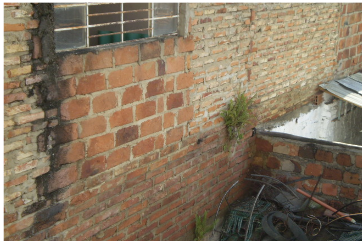
Figura 5-6 Humedad presente en cimientos.
