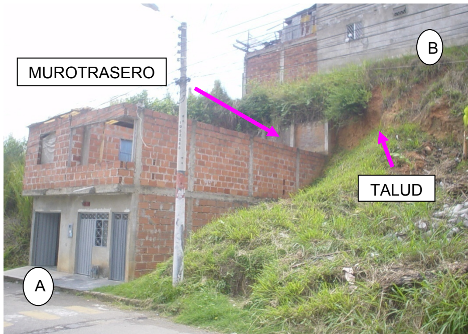
Figura 4-23 Ver talud detrás de la vivienda.
