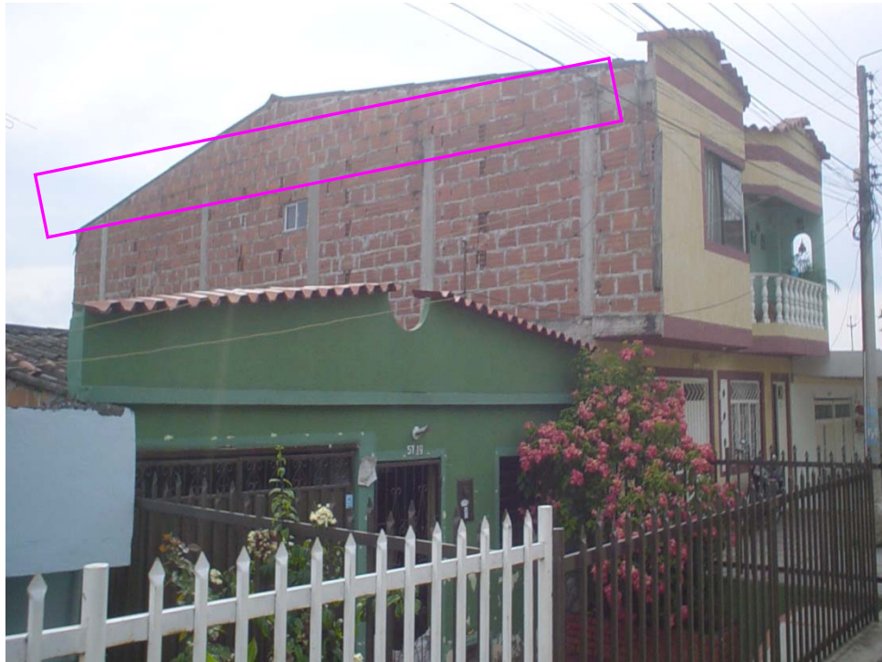
Figura 4-22 Ausencia de viga corona de confinamiento
