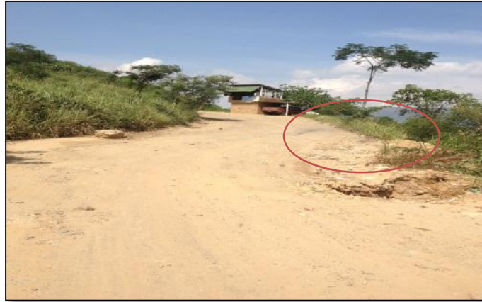
Fotografía 5. Fallas Hundimiento en la vía principal
