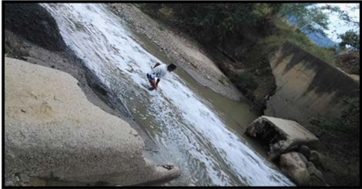
Figura 32. Estructura de mitigación de la velocidad del cauce de la quebrada Chimitá, erosionado y destruido en su parte central. X:1'100.880,532 m Y:1'276.662,736 m H: 679 m.s.n.m (Ver Apéndice G.)
