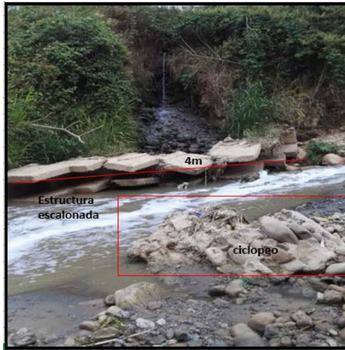
Figura 30. Estructura escalonada para la mitigación de la erosión en la escarpa adyacente a la quebrada Chimitá destruido producto de la socavación lateral. X:1'100.939,444 m, Y:1'276.681,76 m, H:678 m.s.n.m (Ver Apéndice G.)
