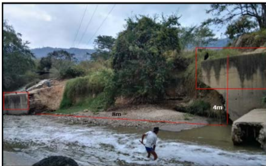
Figura 31. Muro de contención para la mitigación de la escarpa aledaña al cauce de la quebrada Chimitá, erosionado producto de la socavación lateral. X:1'100.880,532 m, Y:1'276.662,736 m, H: 679 m.s.n.m (Ver Apéndice G.)
