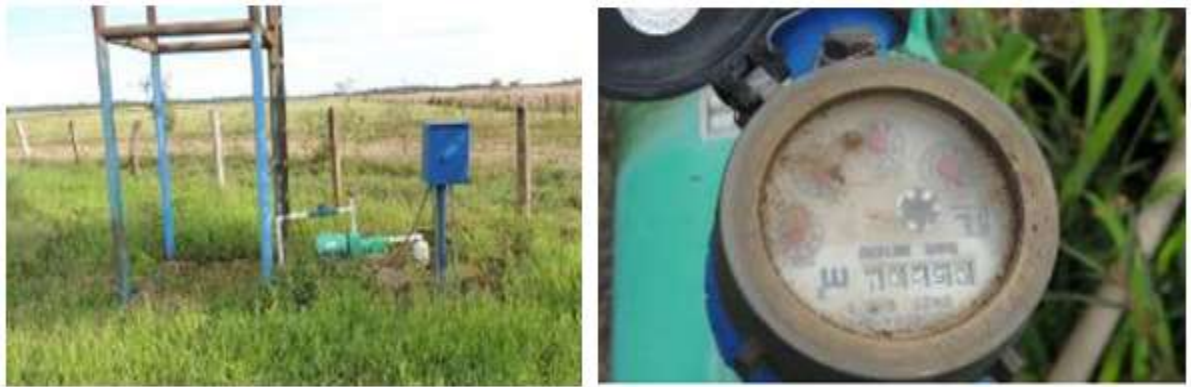
Figura 50. Pozo de captación en la subestación Remache Norte (Fuente: ANLA)
