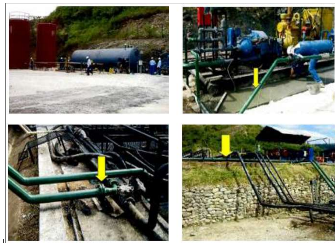
Figura 31. Equipos utilizados para la inyección de agua en el pozo LH-8 (Fuente: ANLA)
