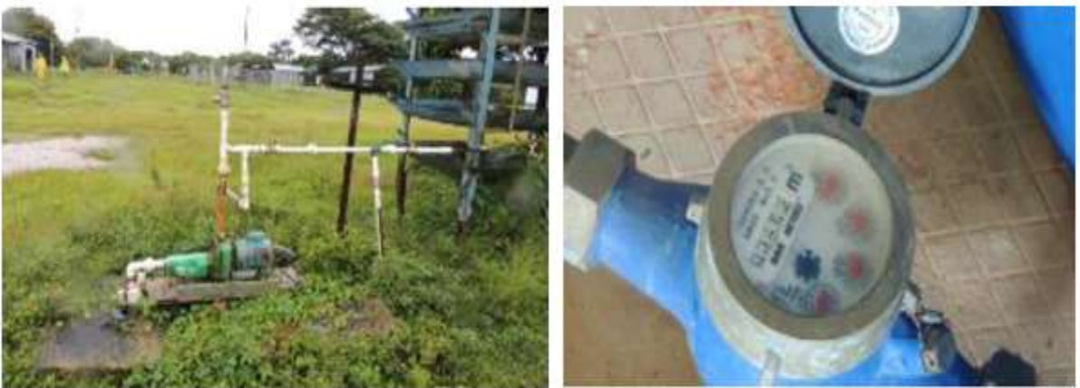
Figura 51. Pozo de captación en la subestación Remache Sur (Fuente: ANLA)
