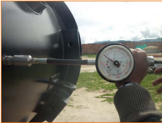
Fotografía N° 32, de la Prueba N° 05
