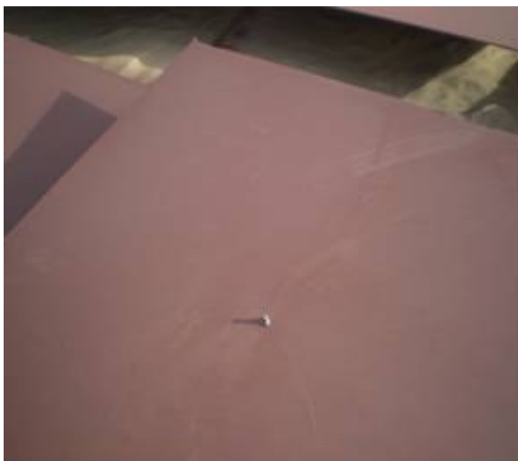
Dado de metal pegado en la lamina para realizar prueba de adherencia. Fuente: Autor.
