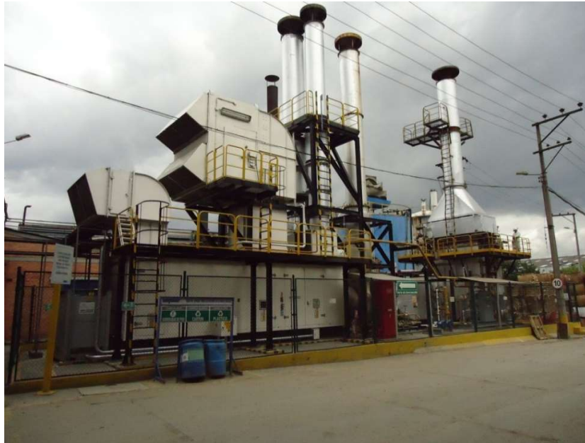
Figura 5. Paquete Turbogenerador - turbina SGT A05 KB7S. Planta Empacor.
