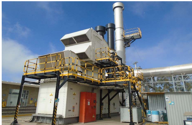
Figura 7. Paquete Turbogenerador de la turbina SGT A05 KB7S.
