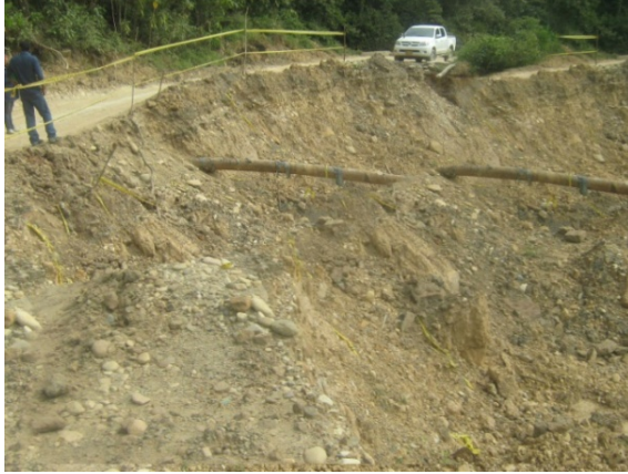
Fotografía 34 Flujo de tierra. Zona Potencialmente inestable.
