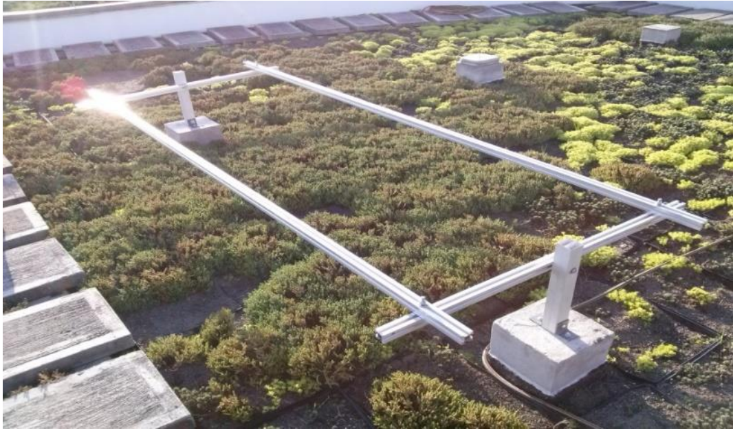
Figura 14. Fotografía de la zona de techo verde del sistema GRIPV #1
