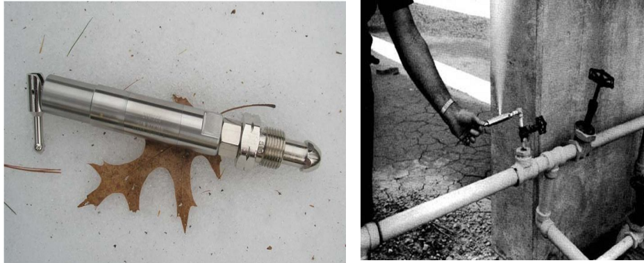
Figura 3. Válvula para indicar contenido de humedad en GLP.
