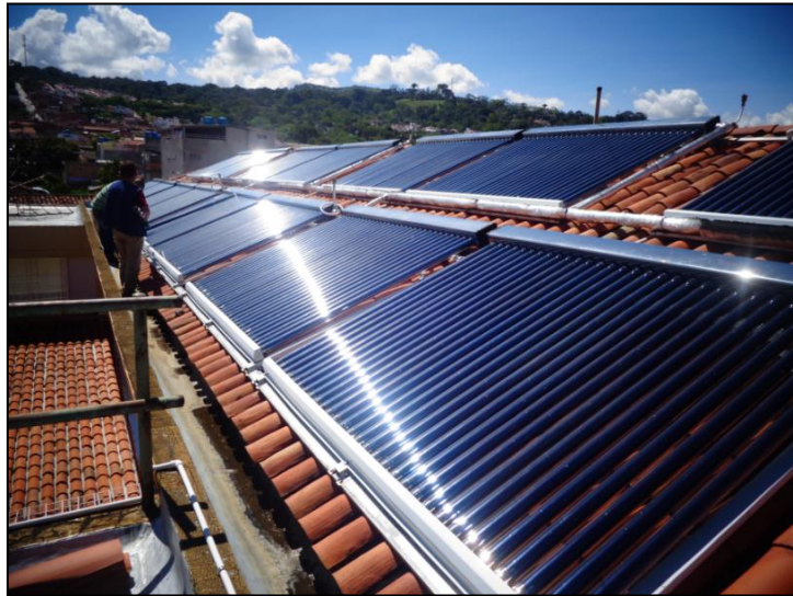
Figura 25. Colectores solares Hospital Manuela Beltrán
