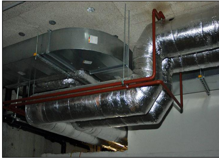
Figura 29. Sistema de tuberías
