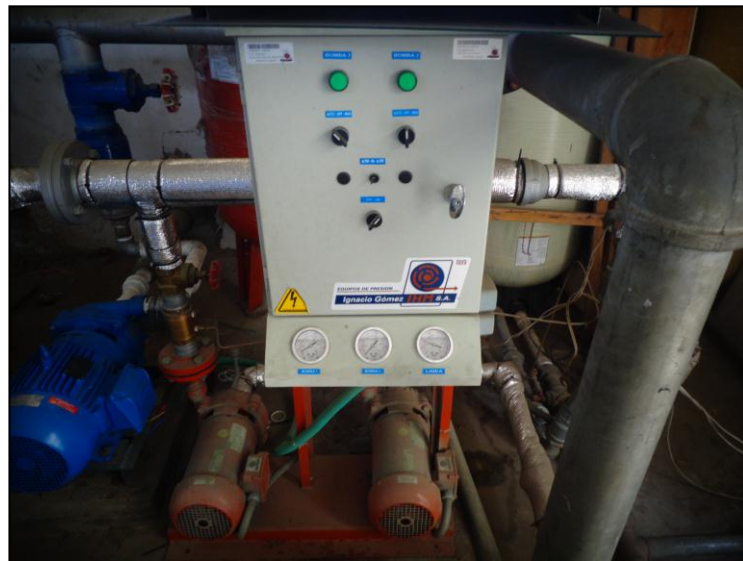
Figura 28. Sistema de bombeo
