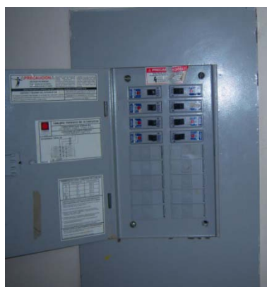
Figura 5. Barraje del tablero TB primer piso
