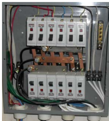
Figura 29. Barraje del tablero TD segundo piso
