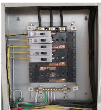
Figura 26. Barraje del tablero TA segundo piso
