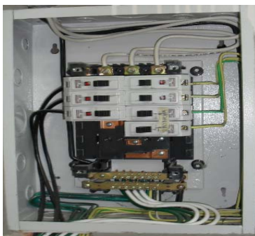
Figura 28. Barraje del tablero TC segundo piso
