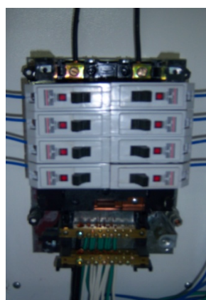
Figura 7. Barraje del tablero TD primer piso
