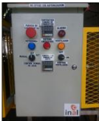
Figura 20. TE con: (1) Accionamiento manual o automático de la motobomba y la turbina, (2) Indicadores y control de Temperatura de llama y Temperatura de vapor de agua.
