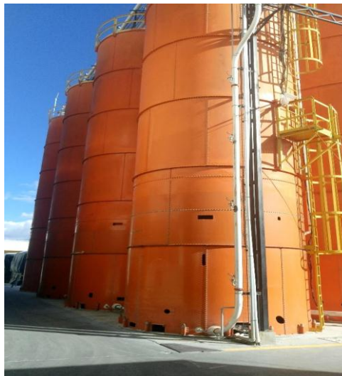
Figura 3. Silos de Almacenamiento Materia Prima
