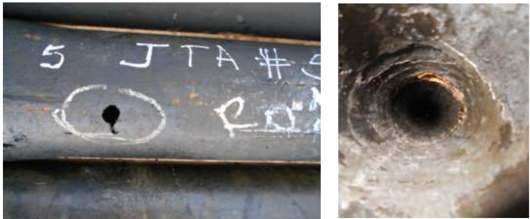
Figura 10. Grietas y daños en las tuberías causados por la corrosión.
