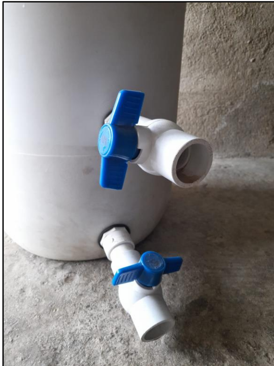
Figura 37. Válvulas de descarga y extracción de lodos
