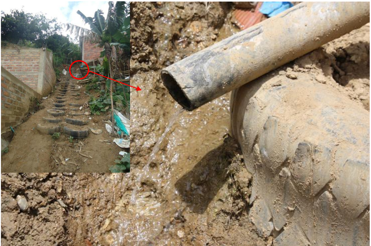
Figura 12. Agua proveniente de la tubería de aducción. Parte alta de la ladera.
