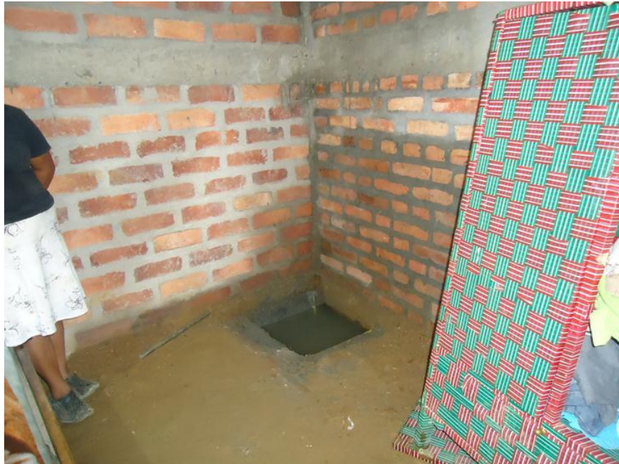
Figura 13. Presencia de agua en las casas del pie del talud.
