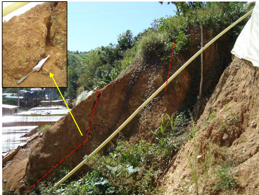
Figura 35. Deslizamiento típico en la zona estudiada, con desprendimientos locales de bloques.
