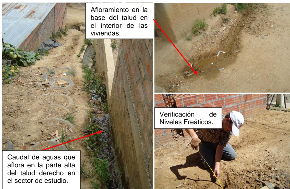
Figura 56. Afloramiento de agua atribuido a filtraciones de la tubería de aducción.
