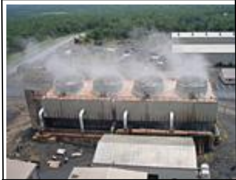
Figura 36. Torres de Refrigeración.
