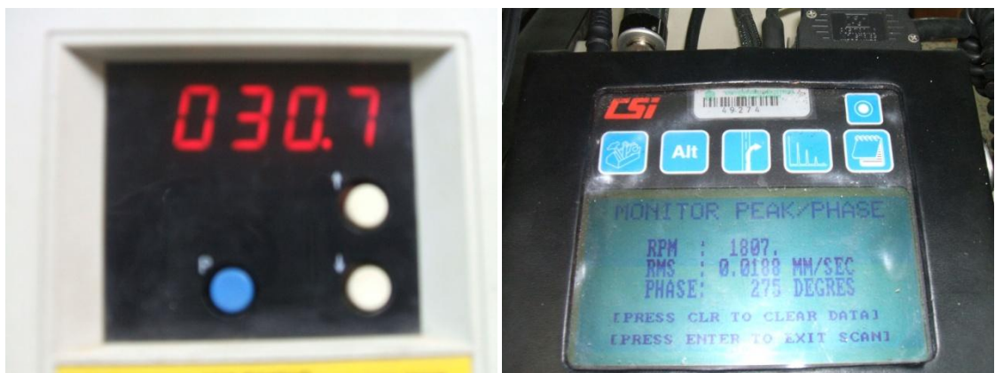
Figura 46 Registro de Inicio de prueba variador y analizador
