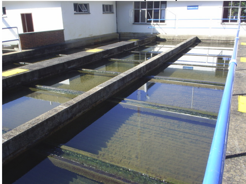
Fotografía 9. Sedimentador de Alta Rata (Placas).Sección de Ampliación.
