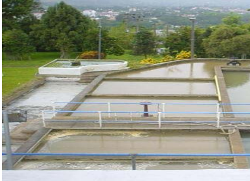
Fotografía 6.Floculadores Mecánicos. Sección Original.
