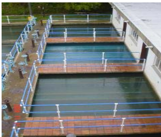
Fotografía 10. Unidades de filtración. Sección Original.
