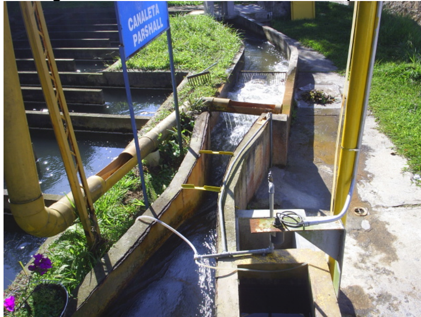
Fotografía 5. Canaleta Parshall. Sección Ampliación.
