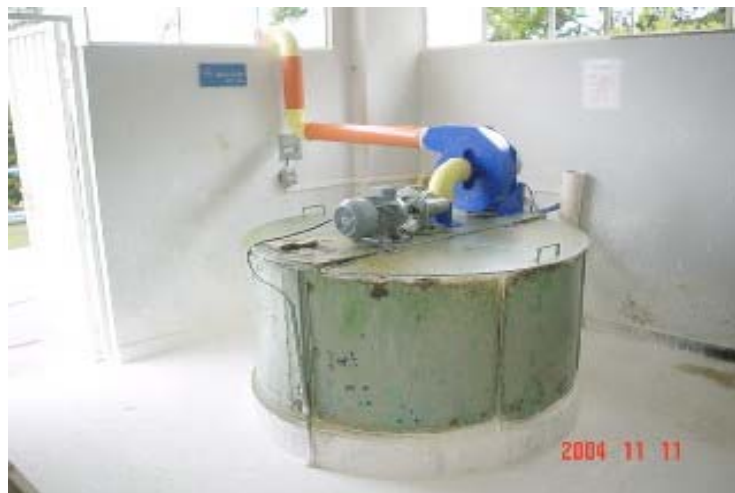
Fotografía 17. Dosificador de cal. Sección Antigua.
