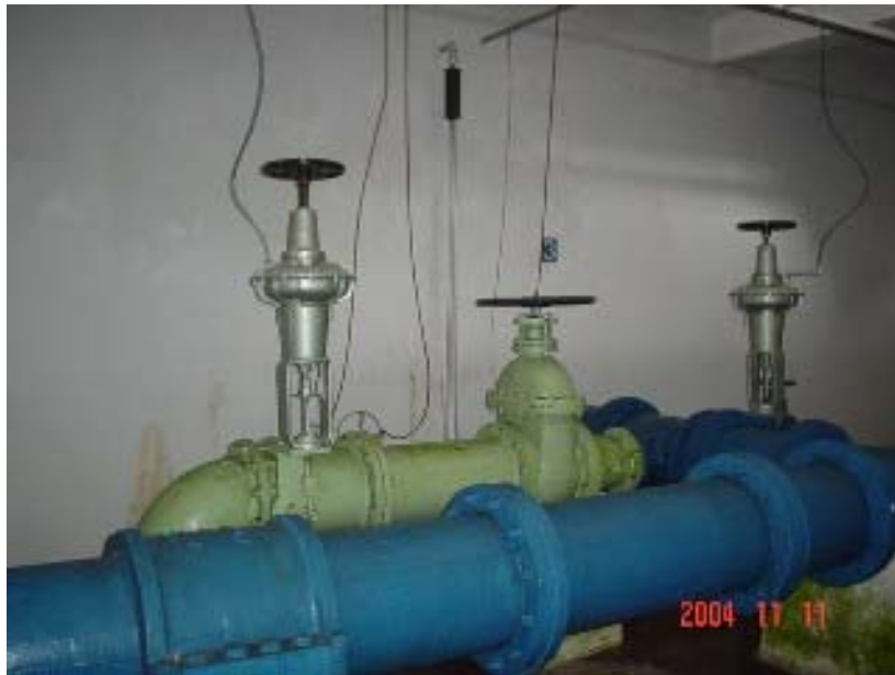
Fotografía 13. Tuberías de Recolección y Transporte de Agua Filtrada.
