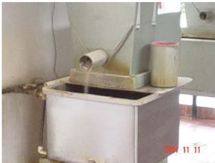
Fotografía 14. Dosificador de Sulfato de Aluminio. Sección Antigua.
