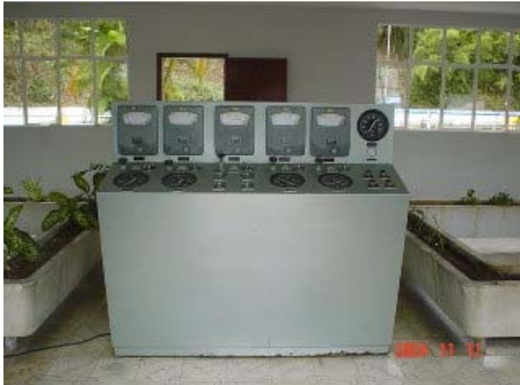
Fotografía 12. Consolas de Control de Operación de Unidades de Filtración.
