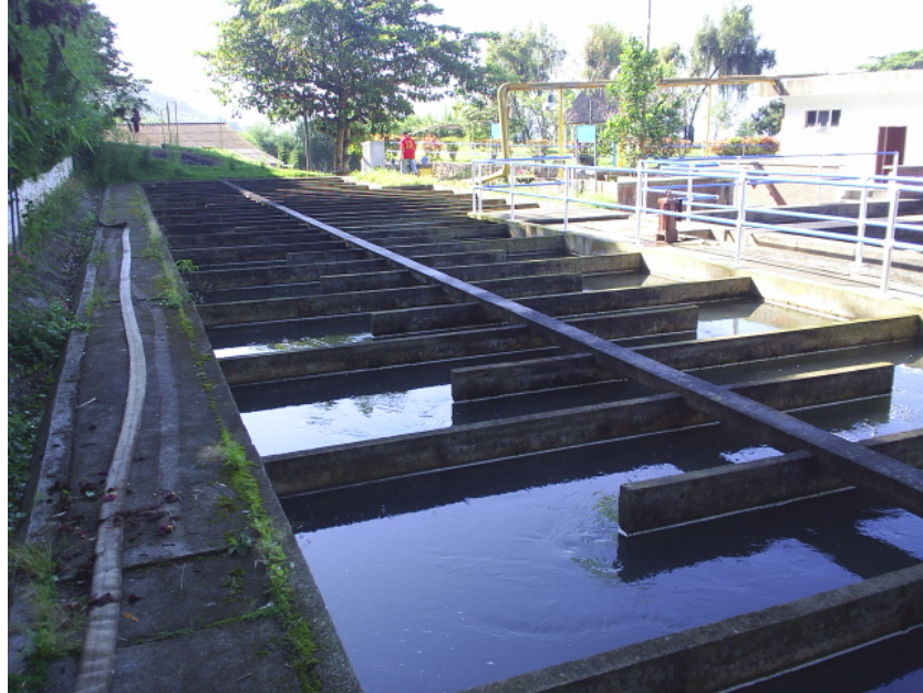
Fotografía 7. S Floculador hidráulico. Sección de Ampliación.
